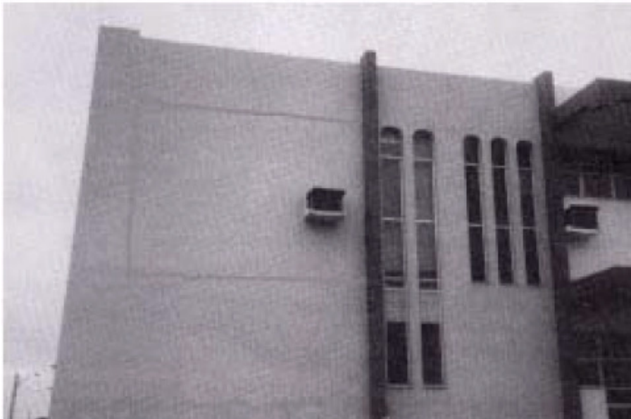
Figura 4 – Fissura de descolamento por movimentação térmica da estrutura de concreto armado com a alvenaria (THOMAZ, 1989)
