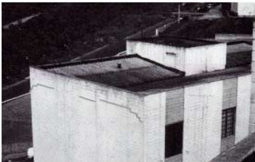
Figura 5 – Fissura de descolamento na platibanda por movimentação térmica (THOMAZ, 1989)
