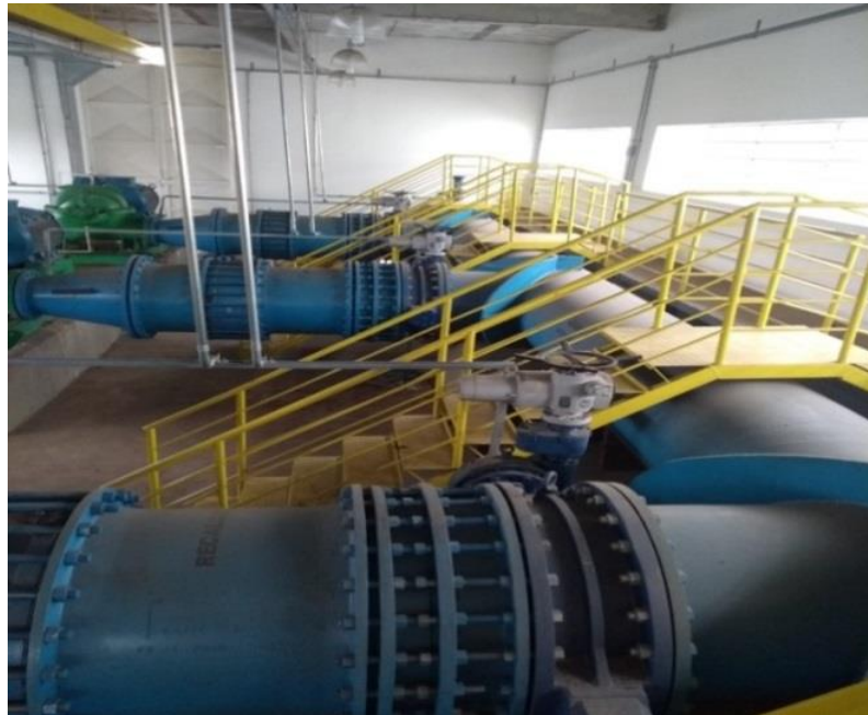
Figura 7 – Barrilete de recalque
