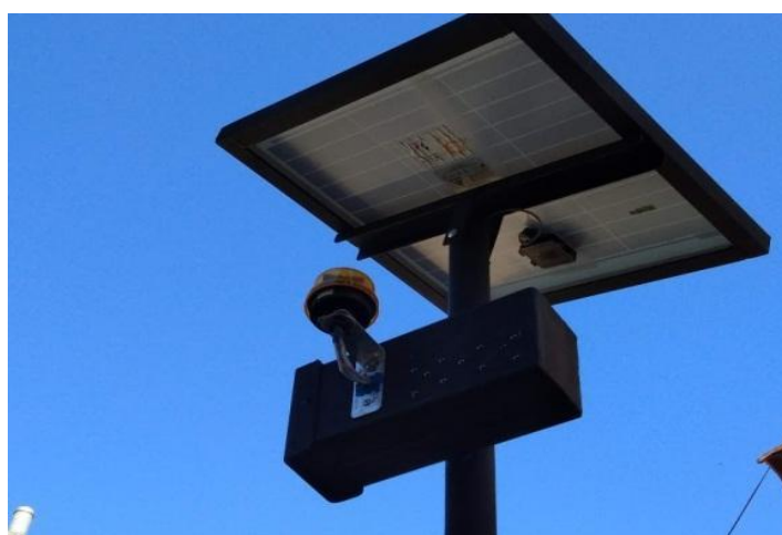
Figura 19 - Disposição da placa, caixa de bateria e controlador e relé fotoelétrico.
