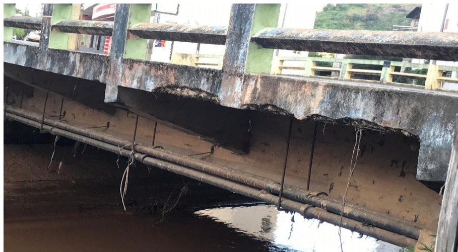
Figura 4.26 Desagregação do concreto e exposição da armadura na ponte 5
