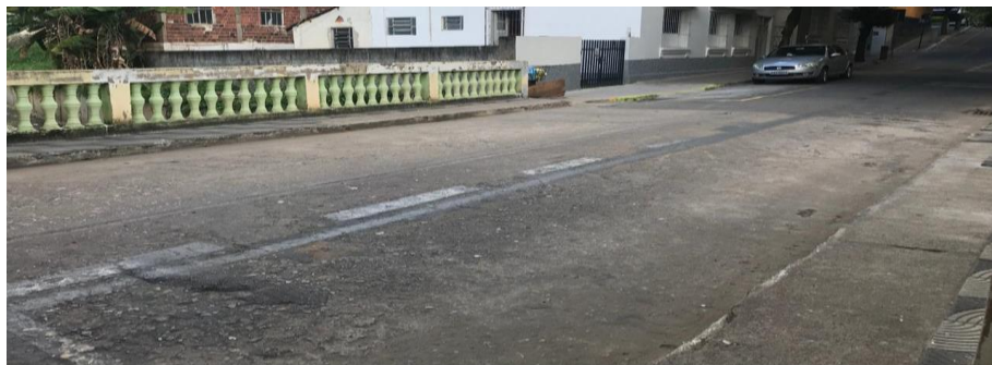
Figura 4.8 Desagregação da pavimentação do tabuleiro na ponte 3
