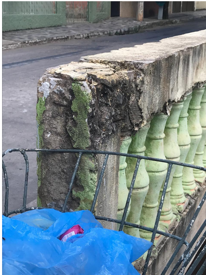
Figura 4.10 Patologias no guarda corpo na ponte 3
