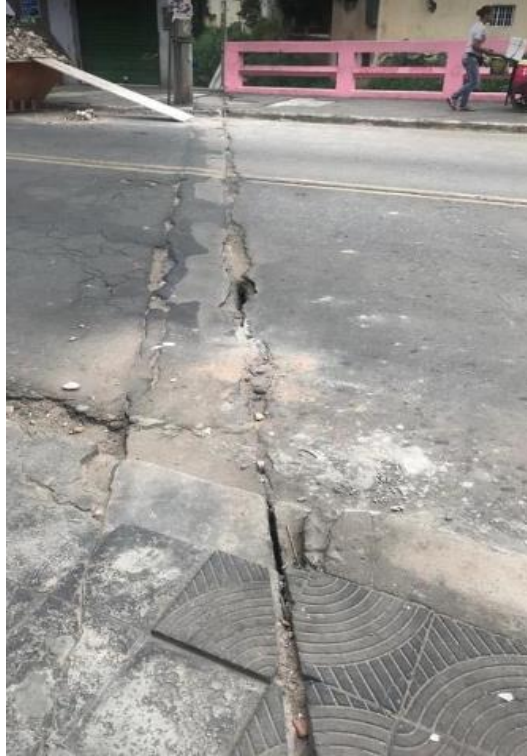
Figura 4.25 Degradação excessiva da junta de encontro da ponte 5
