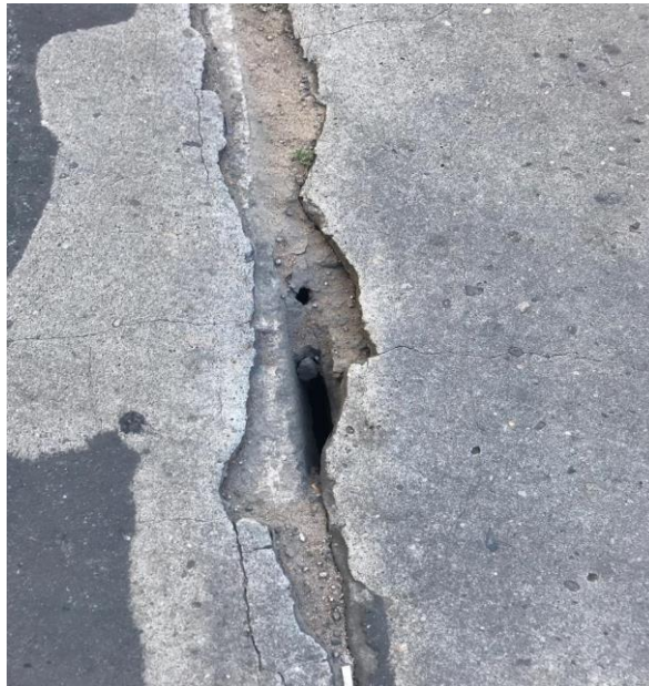
Figura 4.23 Ruptura da junta de encontro na ponte 5
