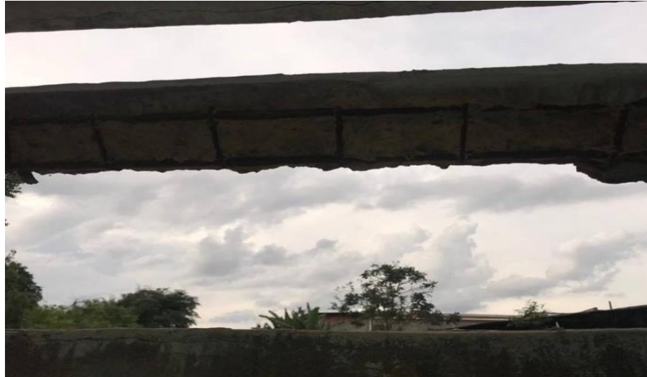
Figura 4.35 Armadura exposta no guarda corpo na ponte 7
