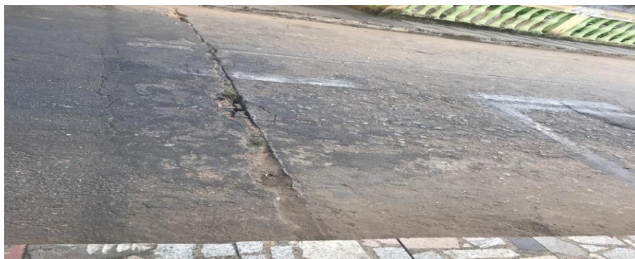
Figura 4.9 Aberturas excessivas nas juntas de encontro na ponte 3
