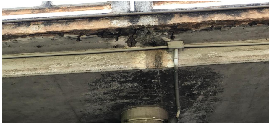
Figura 4.36 Deslocamento do concreto e exposição da armadura no viaduto
