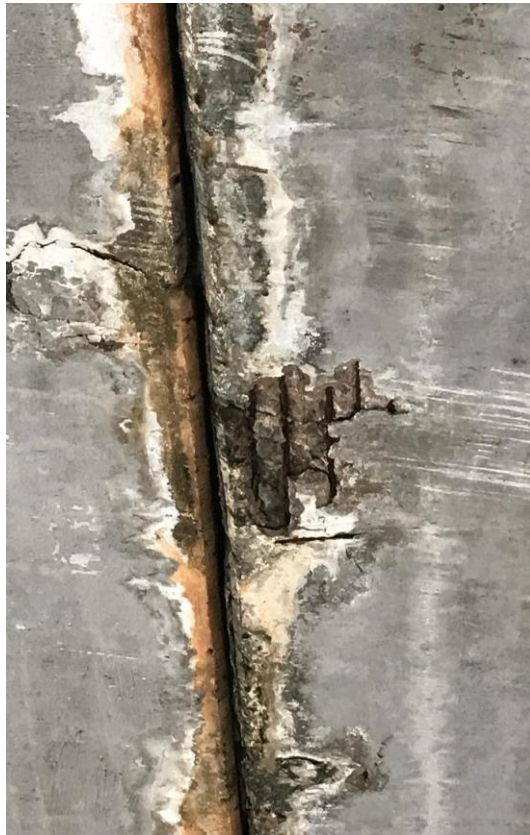
Figura 4.38 Exposição e corrosão da armadura na junta de dilatação no viaduto
