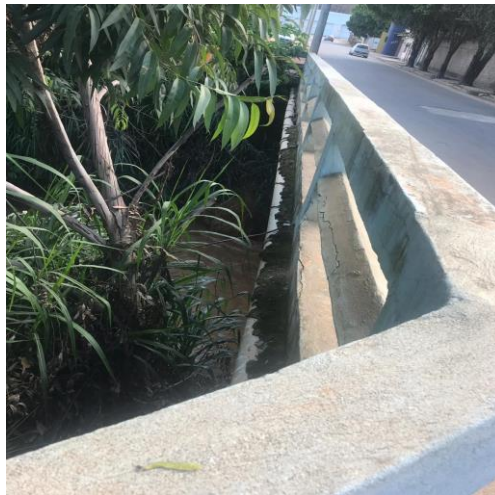
Figura 4.33 Lodos na parte lateral do guarda corpo da ponte 7
