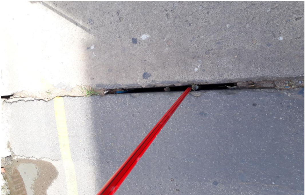
Figura 4.16 Abertura excessiva nas juntas entre o tabuleiro e a calçada na ponte 3
