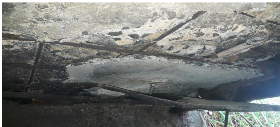
Figura 4.32 Desgaste da pasta de cimento e exposição da armadura da ponte 7
