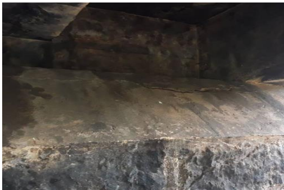
Figura 4.7 Trincas, desagegação do concreto e infiltrações na parte inferior da ponte 2
