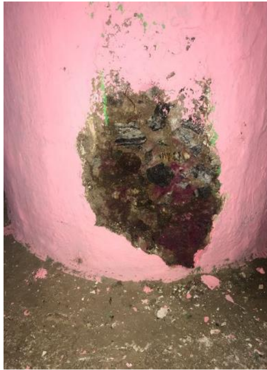
Figura 4.53 Superfície do viaduto depois do ensaio no primeiro pilar
