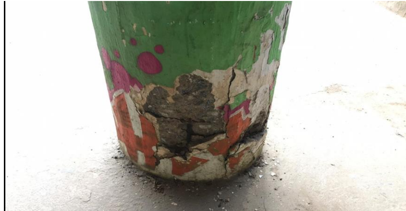
Figura 4.42 Fissuras, deslocamento e exposição da armadura na base do pilar do viaduto
