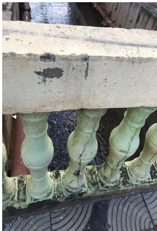
Figura 4.18 Fissuras no guarda corpo da ponte 4
