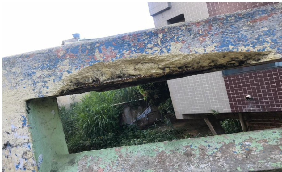
Figura 4.22 Exposição da armadura no guarda corpo da ponte 5
