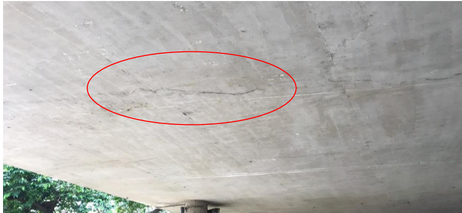
Figura 4.40 Fissuras na parte inferior da laje do tabuleiro no viaduto
