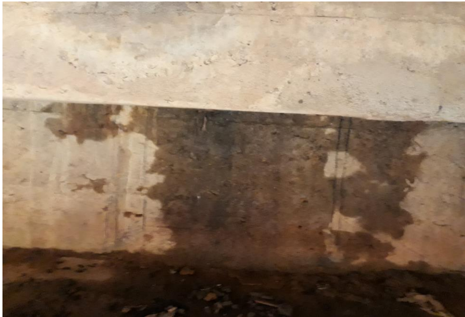
Figura 4.13 Infiltração na lateral da ponte da ponte 4
