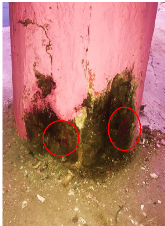
Figura 4.54 Superfície do viaduto depois do ensaio no segundo pilar
