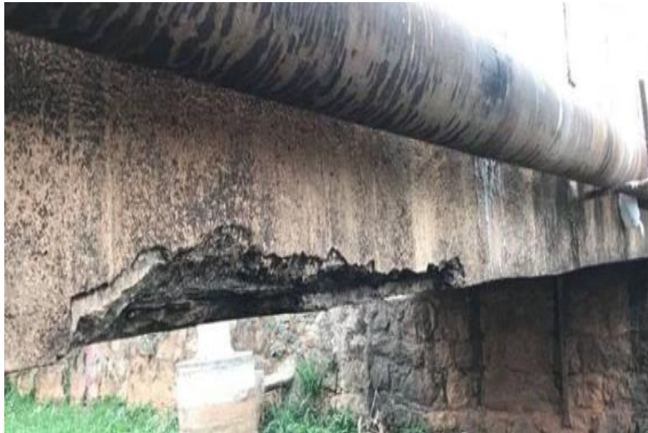
Figura 4.46 Superfície da ponte 2 após o ensaio
