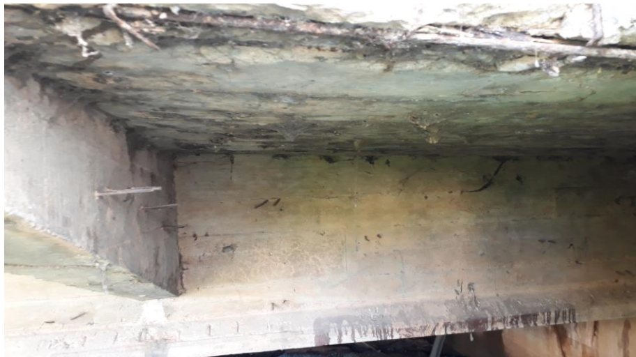
Figura 4.3 Evidente exposição da armadura na parte inferior lateral do tabuleiro na ponte 1
