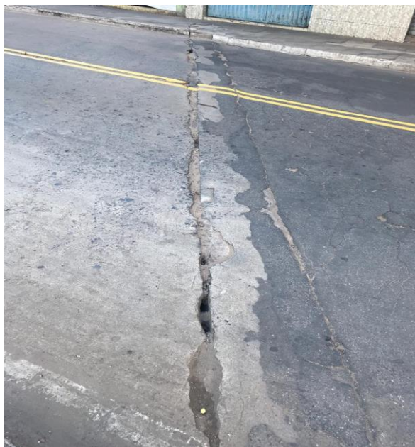
Figura 4.24 Aberturas excessivas nas juntas de encontro da ponte 5
