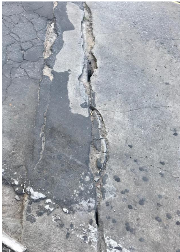
Figura 4.14 Ruptura da junta de encontro da ponte 4
