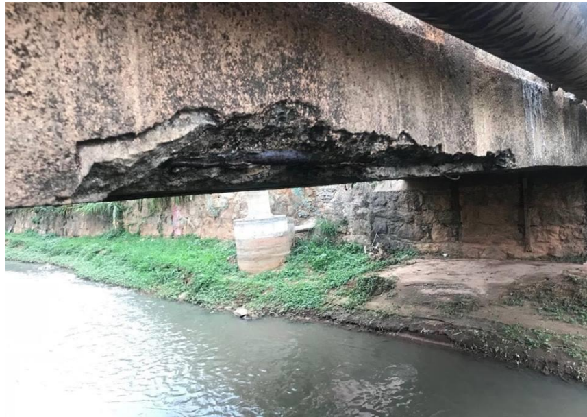
Figura 4.6 Desagregação do concreto e exposição da armadura na ponte 2
