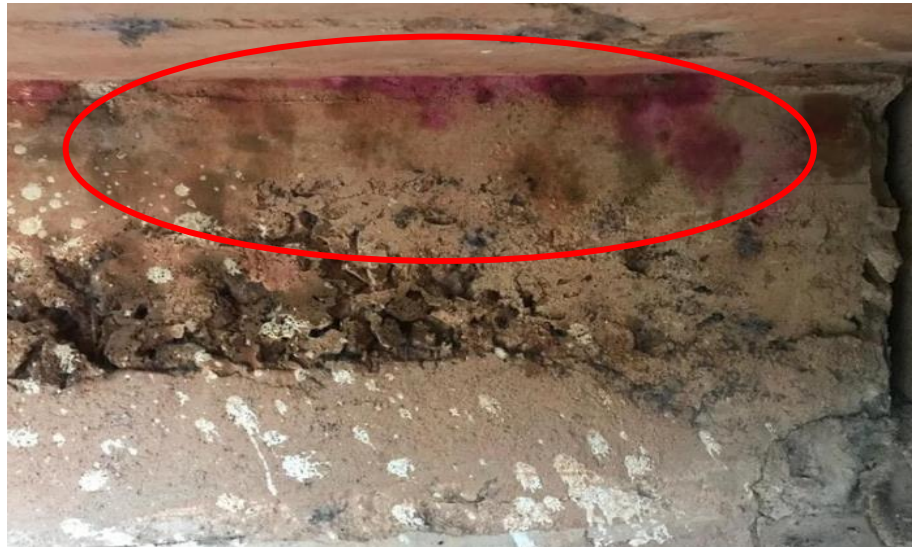
Figura 4.48 Superfície da ponte 3 depois do ensaio
