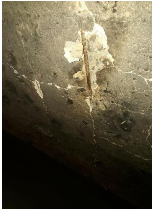
Figura 4.52 Superfície da ponte 7 depois do ensaio
