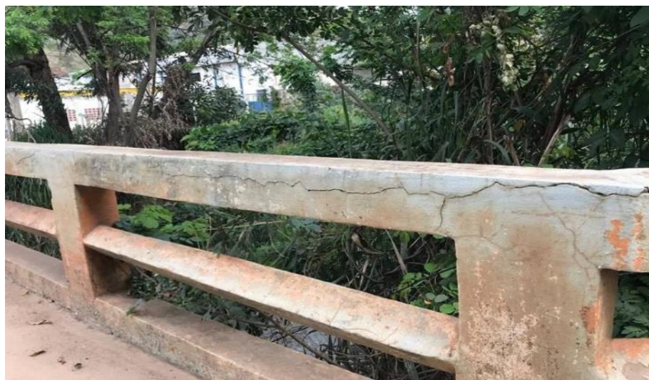
Figura 4.34 Fissuras no guarda corpo da ponte 7
