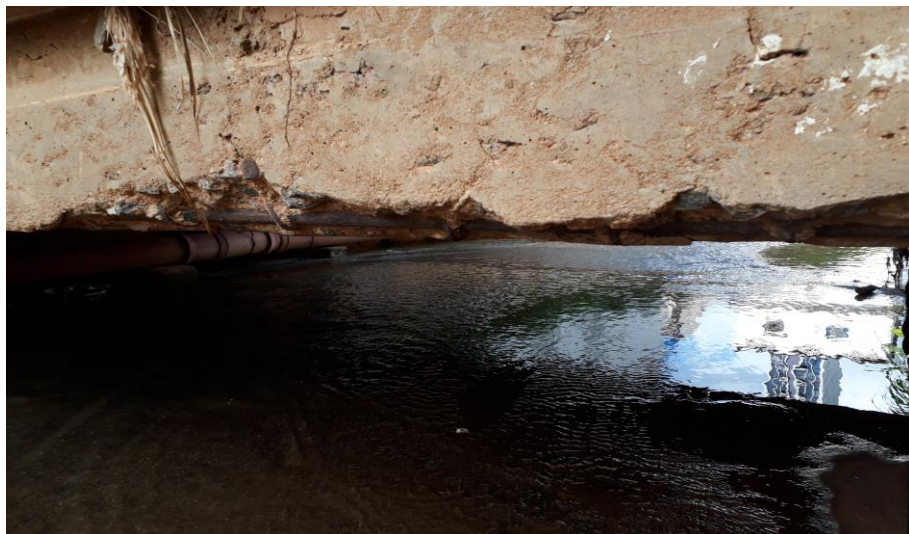
Figura 4.12 Desgaste da pasta de cimento e armaduras exposta na ponte 4
