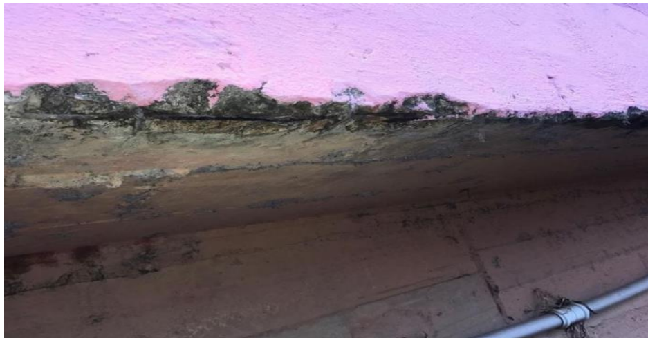
Figura 4.50 Superfície da ponte 4 depois do ensaio
