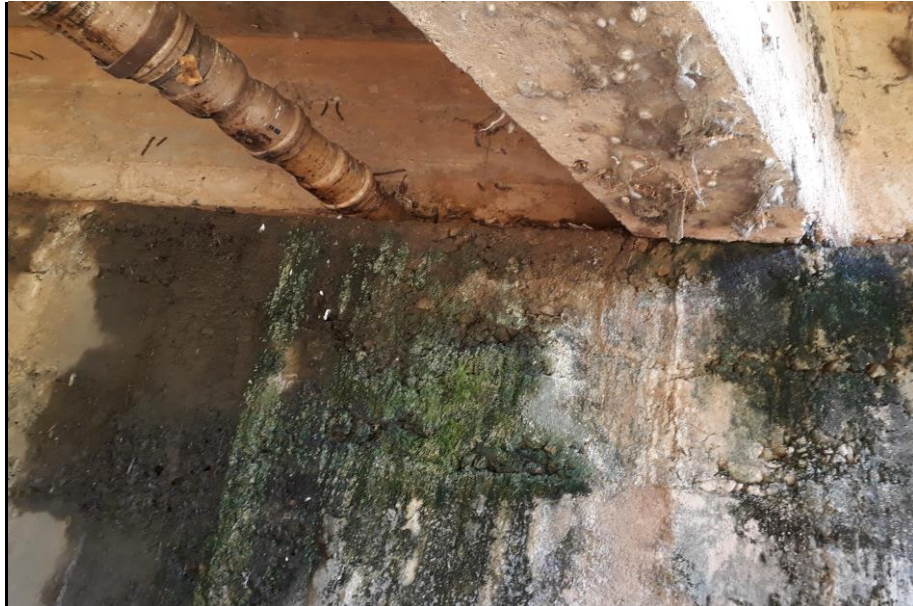
Figura 4.21 Lodo e infiltração na parte inferior da ponte 5
