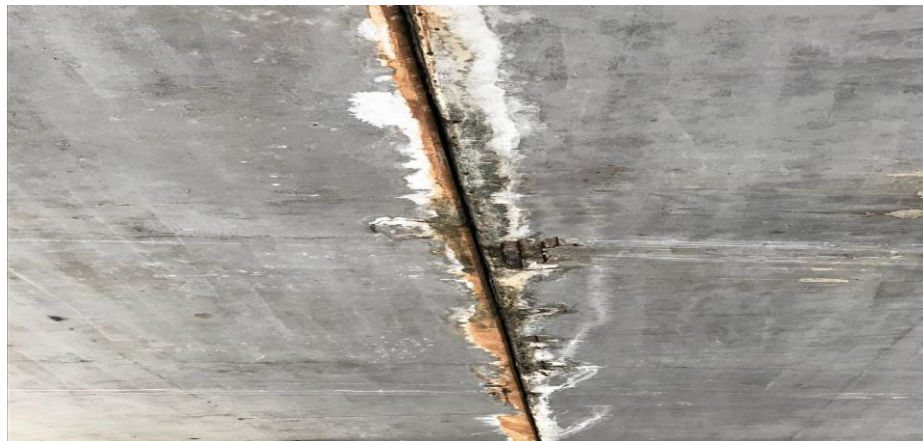
Figura 4.37 Patologias nas juntas de dilatação no viaduto
