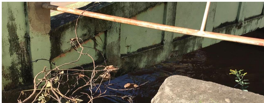
Figura 4.5 Lodos no guarda corpo na ponte 2
