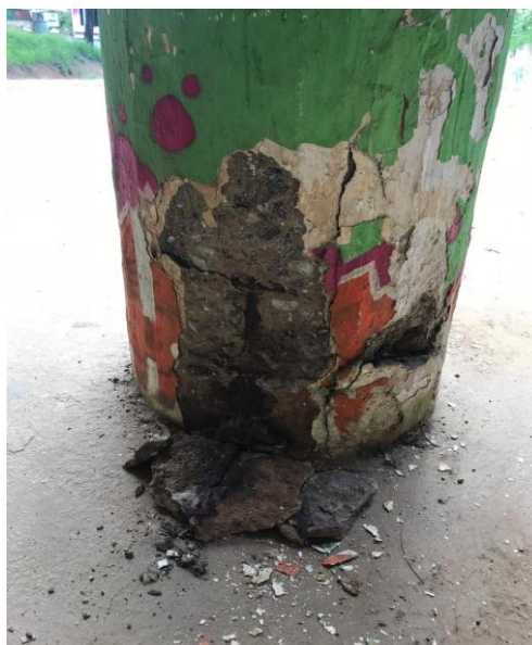
Figura 4.41 Deslocamento e exposição da armadura na base do pilar do viaduto
