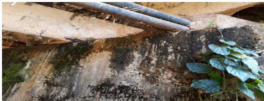
Figura 4.20 Desgaste da pasta de cimento na ponte 5
