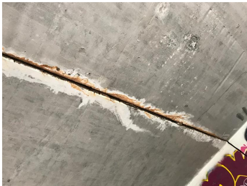
Figura 4.39 Aberturas excessivas das juntas de dilatação no viaduto
