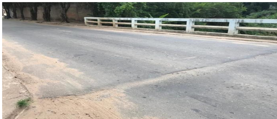
Figura 4.31 Desnível entre o tabuleiro e o pavimento na ponte 7
