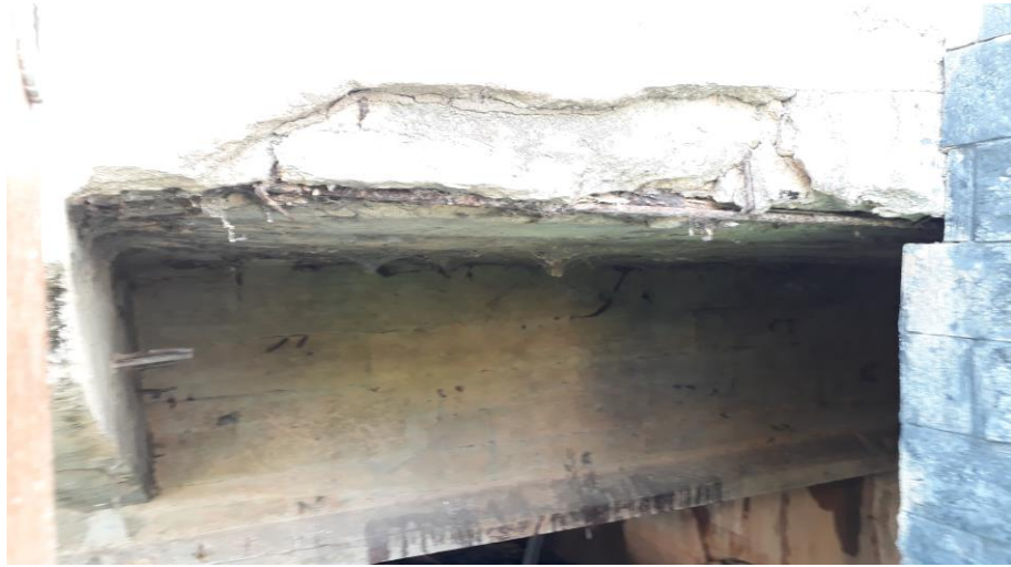
Figura 4.2 Deslocamento do concreto e exposição da armadura na ponte 1
