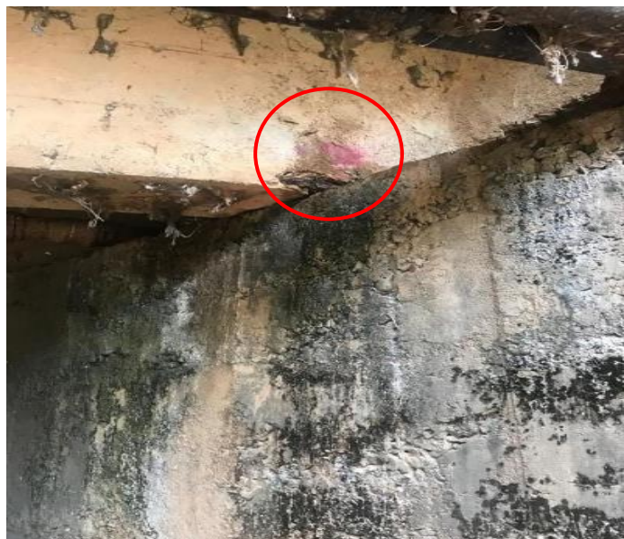
Figura 4.51 Superfície da ponte 5 depois do ensaio
