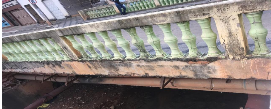
Figura 4.19 Exposição da amadura na parte inferior lateral da passarela na ponte 4
