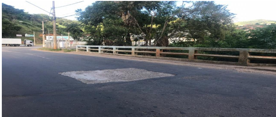
Figura 4.30 Desgaste do pavimento na ponte 7
