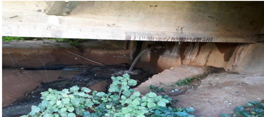
Figura 4.4 Infiltrações na parte inferior da ponte 1
