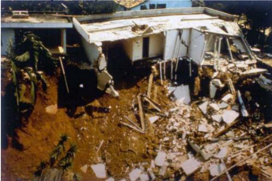
Figura 15 – Registro da subsidência em Cajamar, 1986
