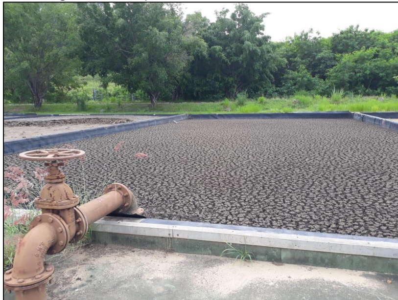
Figura 7: Tanque de armazenamento do lodo
