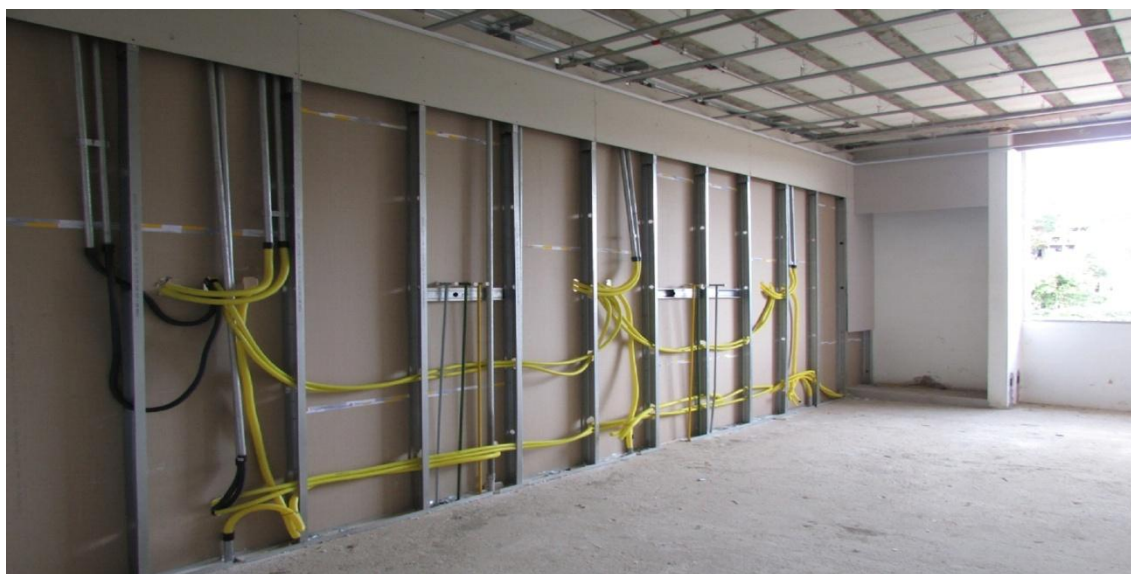
FIGURA 10 - Assentamento de placas, execução de instalação elétrica e rede para gases medicinais (HRTO)
