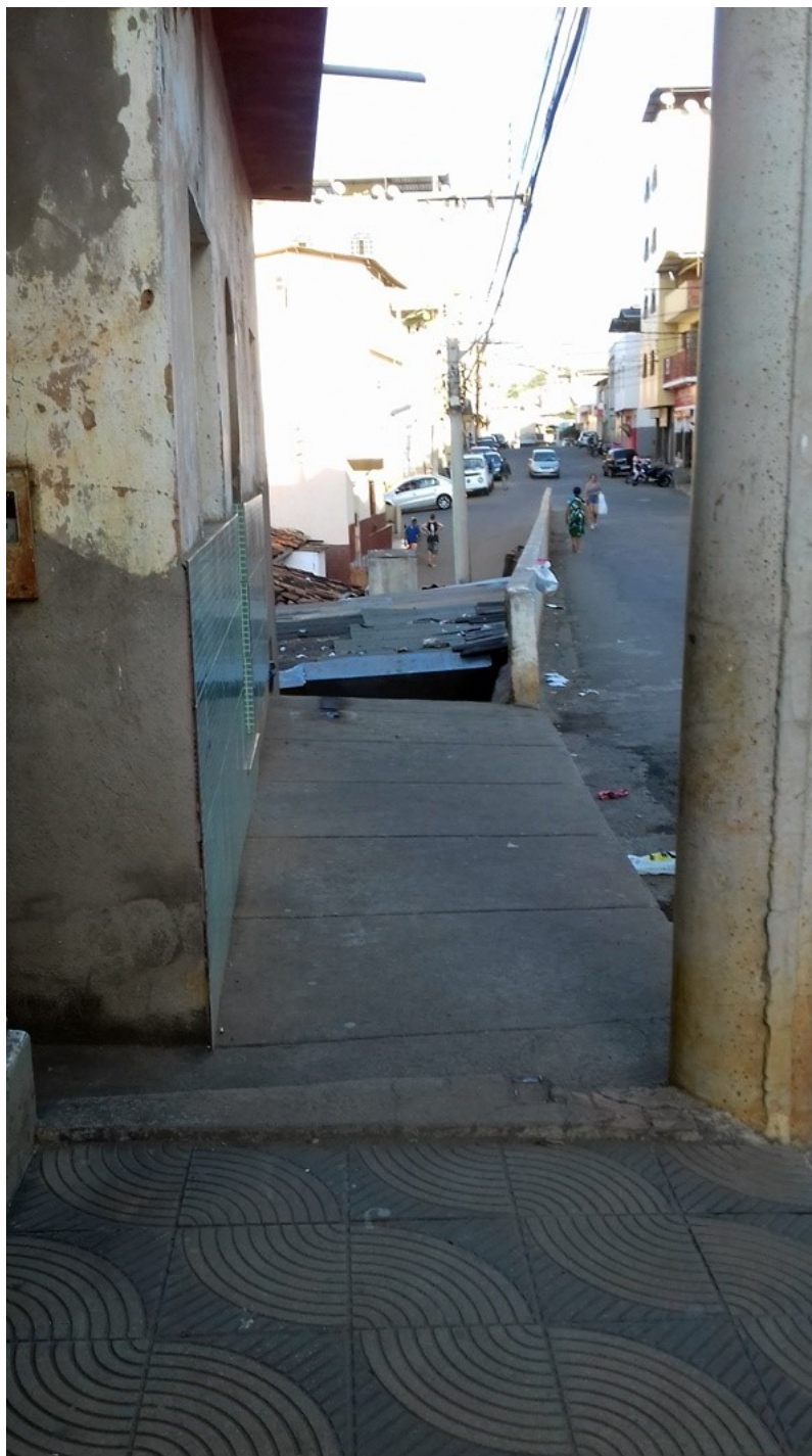
Figura 33: Ausência de Passeio
