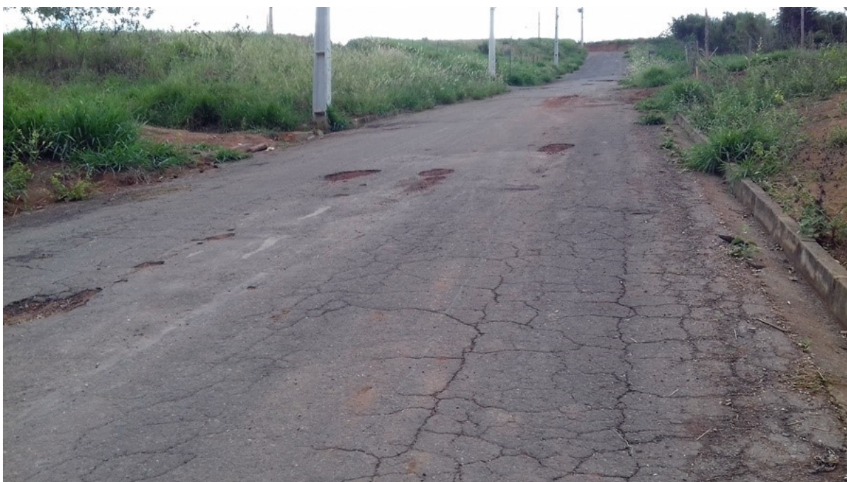
Figura 11: Asfaltamento recém executado em péssimo estado.
