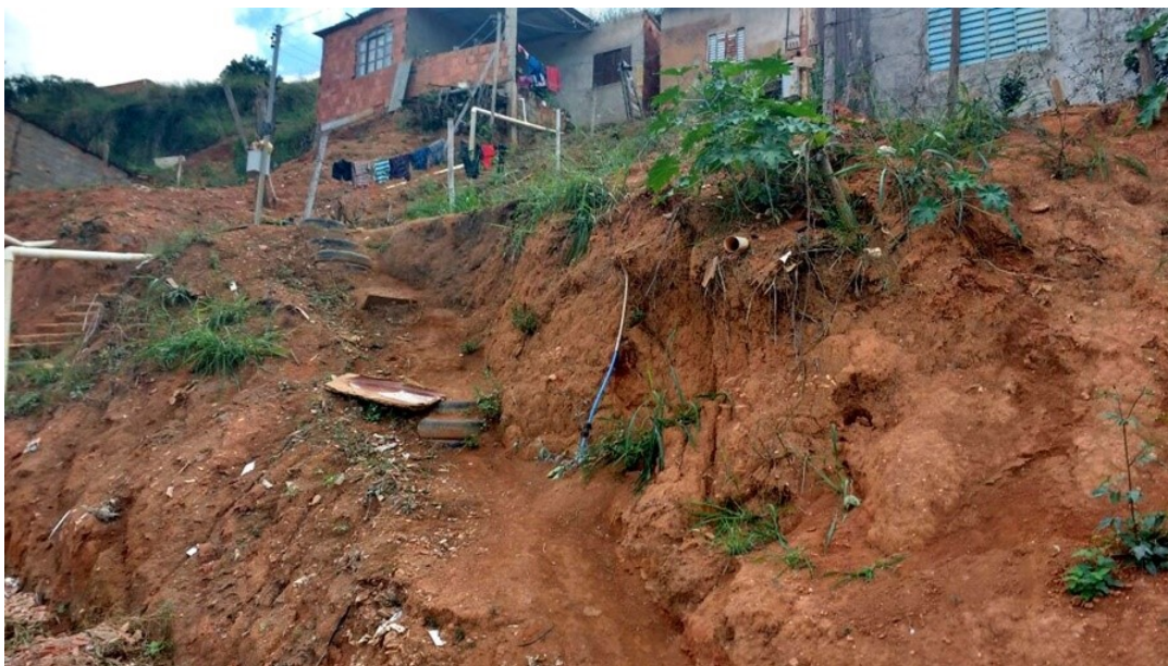
Figura 8: Construção em local de risco.
