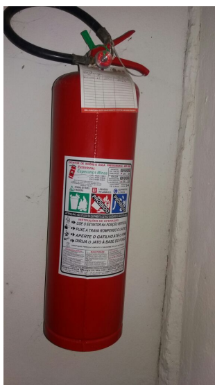
Figura 12: Extintor Classe A Fonte: Acervo do autor.
