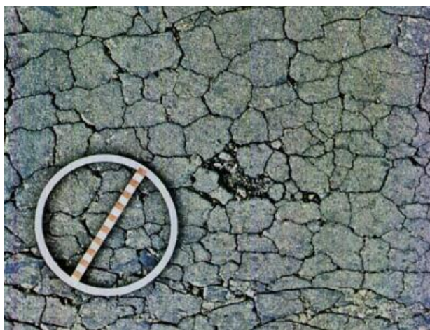
Figura 14 – Trincas no pavimento
