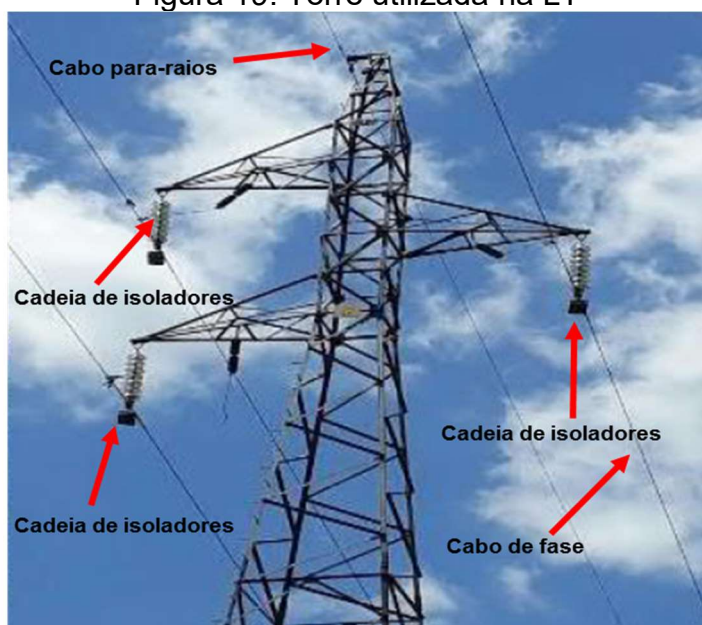
Figura 19: Torre utilizada na LT
