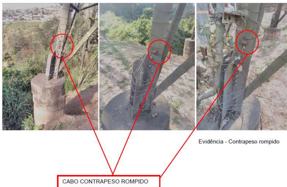
Figura 25: Torre 01 com cabos contrapeso rompidos
