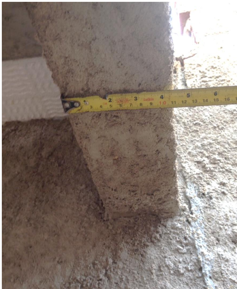
Figura 5.1: Caso 01 – viga com menor dimensão de 10 cm.
