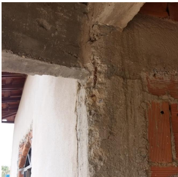
Figura 5.15: Caso 02 – armadura exposta em pilar.
