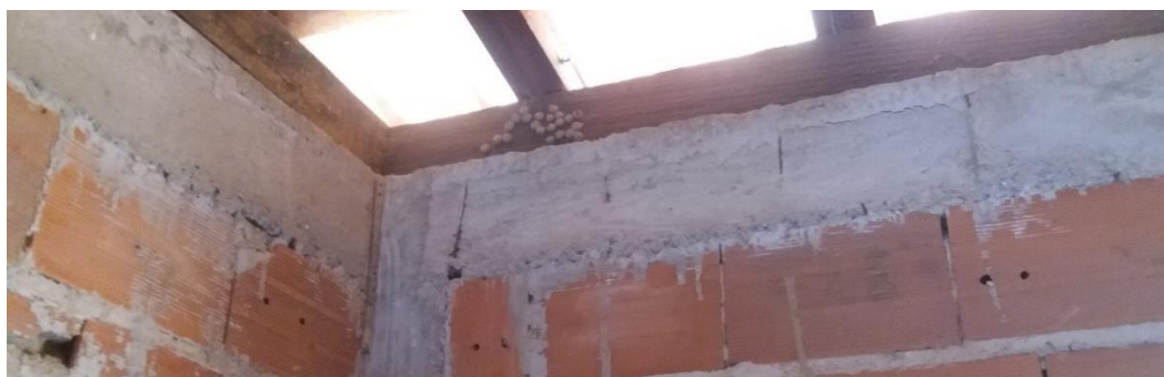
Figura 5.16: Caso 02 – viga com cobrimento irregular.
