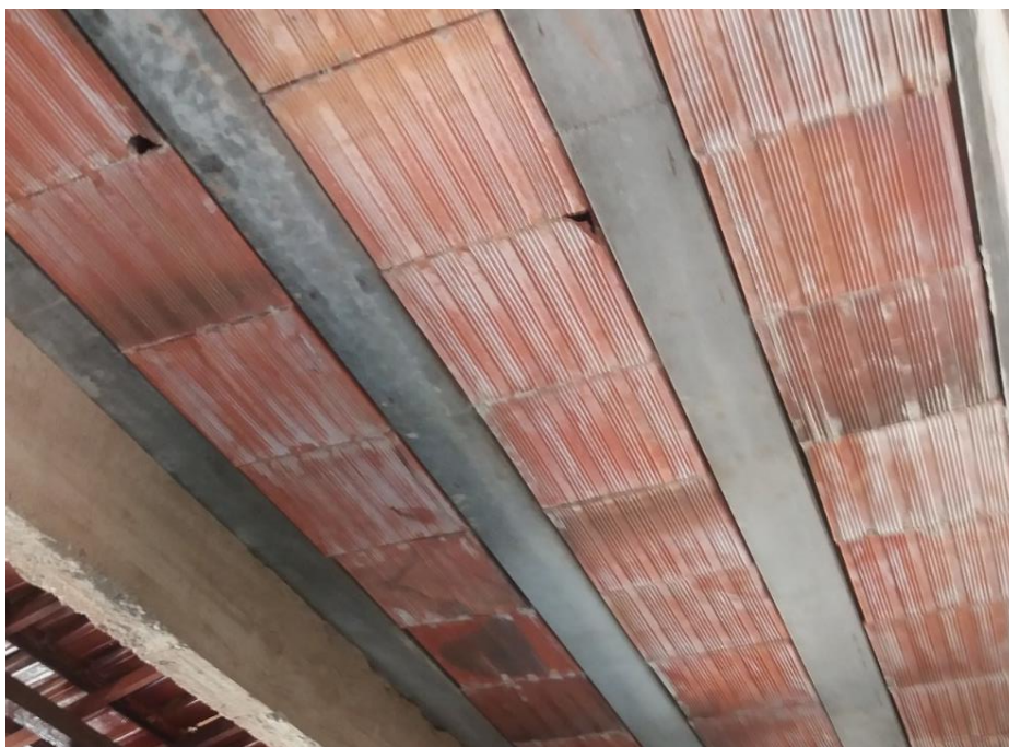
Figura 4.19: Caso 02 – laje pré-moldada.
