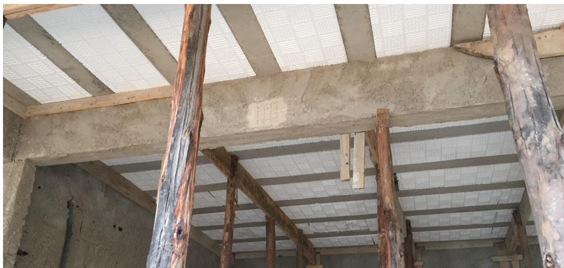
Figura 4.8: Caso 01 – vigas do segundo pavimento.
