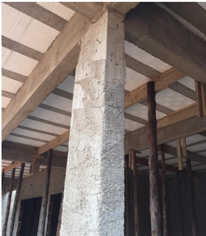
Figura 4.11: Caso 01 – Pilar do primeiro pavimento.
