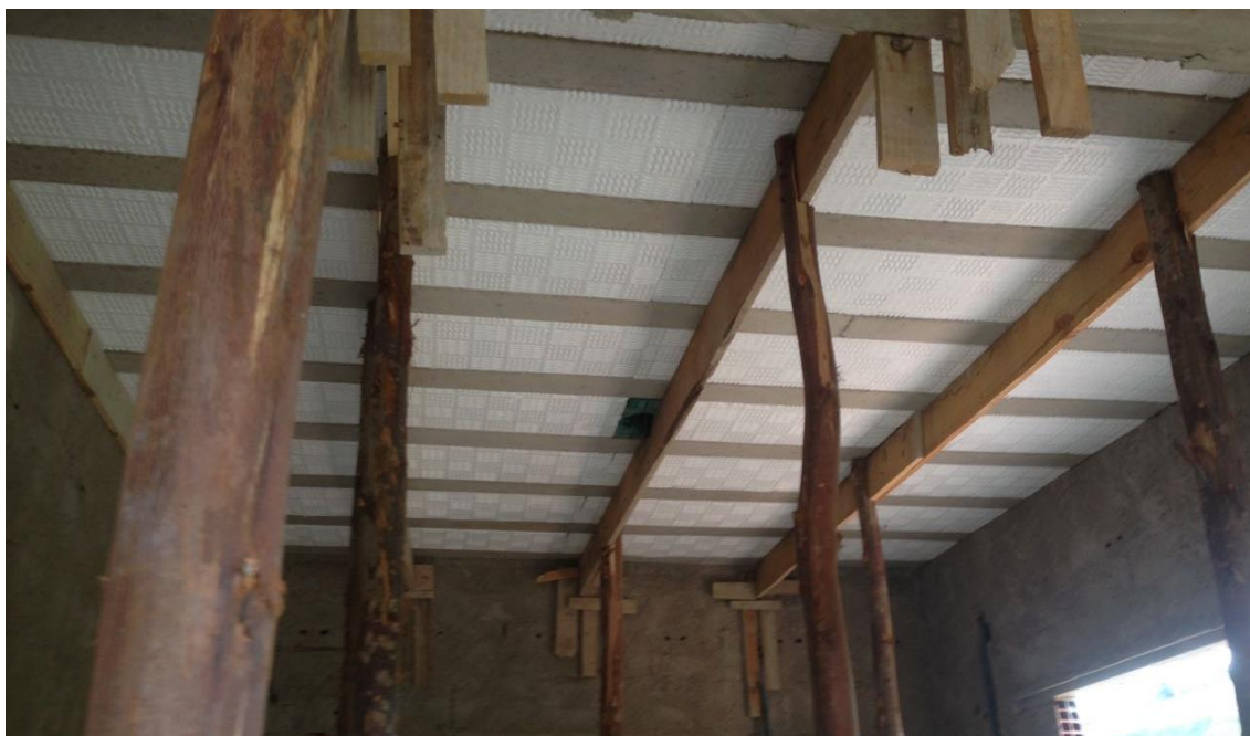
Figura 4.5: Caso 01 – laje pré-moldada.
