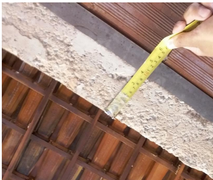
Figura 5.13: Caso 02 – viga com menor dimensão de 10 cm.
