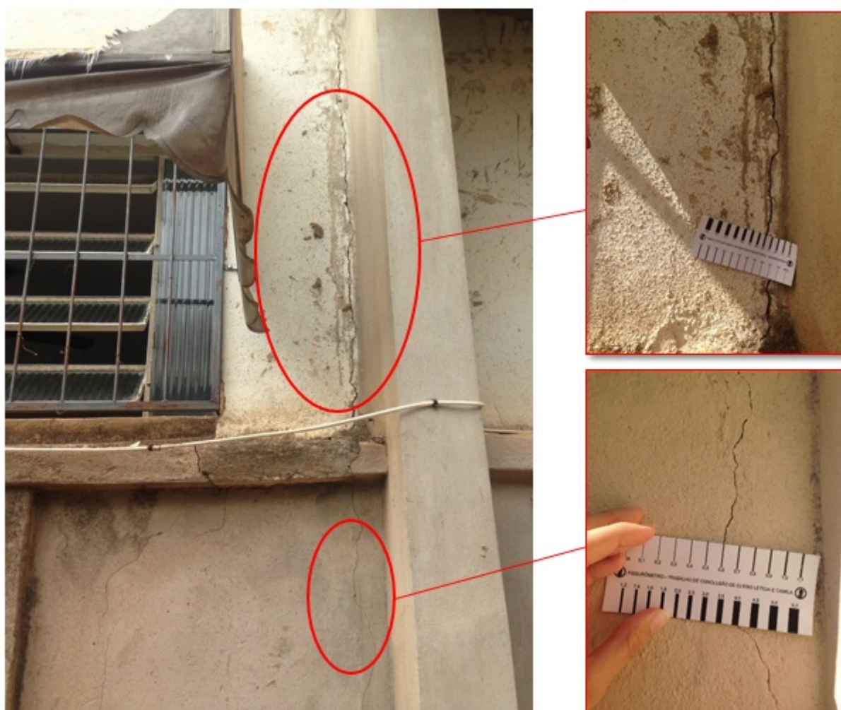
Figura 57: Vista aproximada da parede onde se encontra a fissura, nos fundos da edificação.
