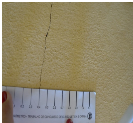
Figura 88: Vista aproximada da fissura L, na parede voltada para o lado da sala de estar, na divisão quarto/sala.
