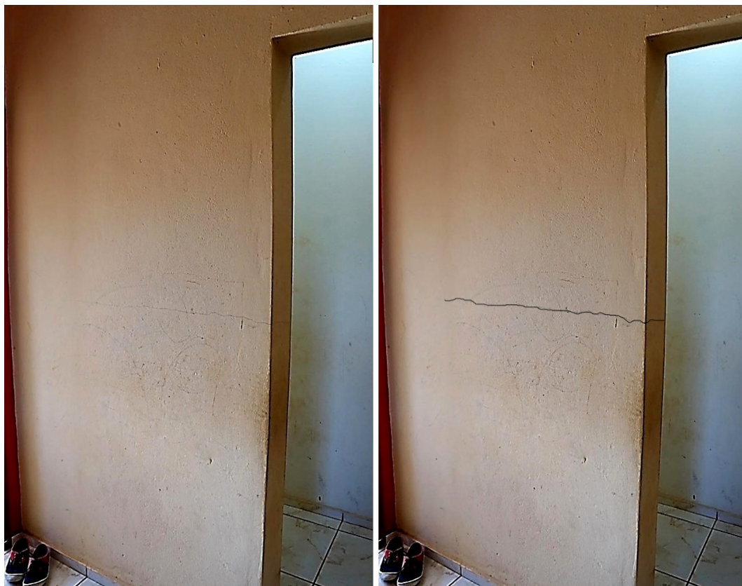
Figura 86: Vista da parede fissurada, voltada para o lado da sala de estar, na divisão quarto/sala, realçada com editor de imagens
