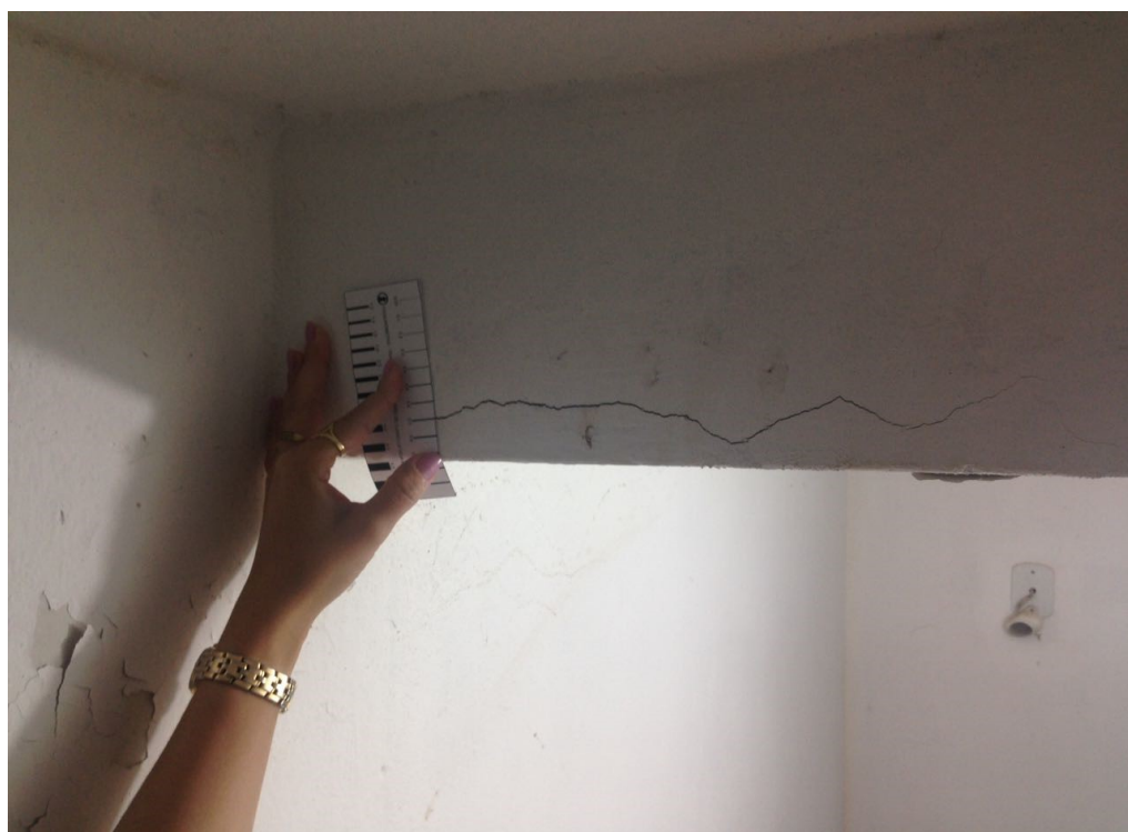
Figura 68: Medição da espessura da fissura localizada na viga.
