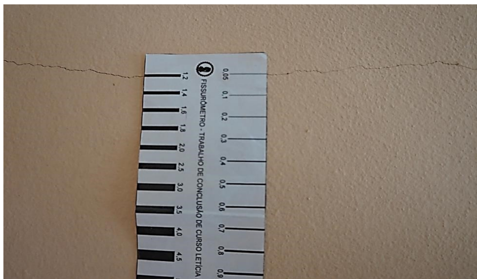
Figura 72: Vista aproximada da Fissura H.
