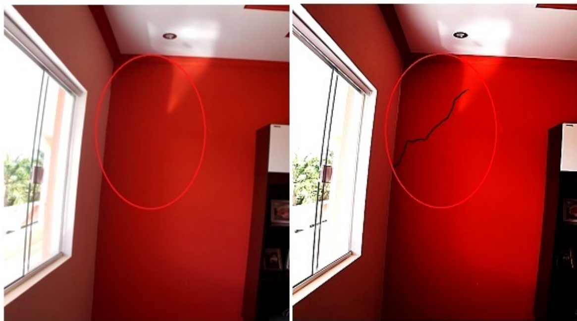
Figura 77: Vista da parte interna da parede da sala de estar, realçada com editor de imagens.
