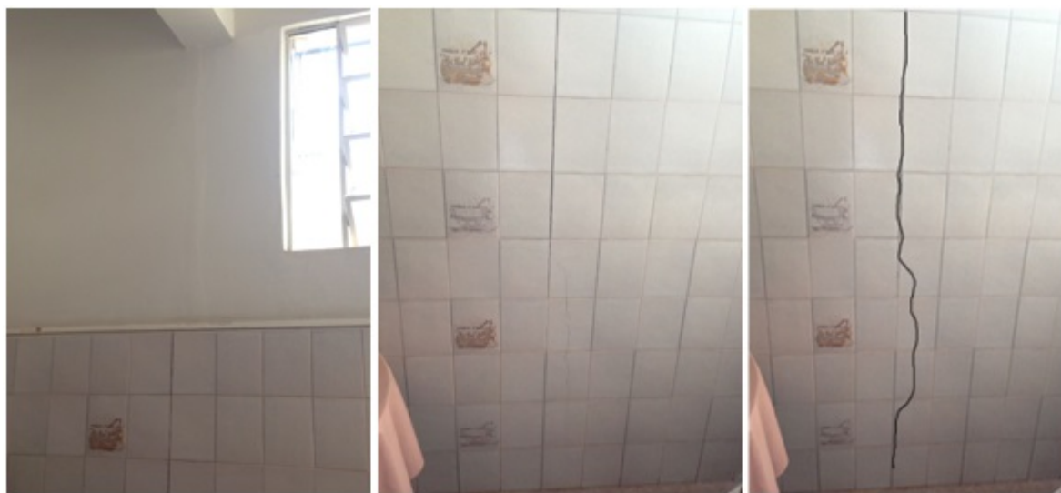
Figura 56: Vista da parte interna da parede onde se encontra a fissura, realçada com editor de imagens.
