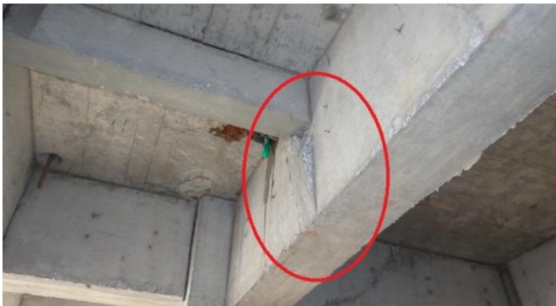
Figura 7: Exemplo de trinca devido à movimentação de formas.
