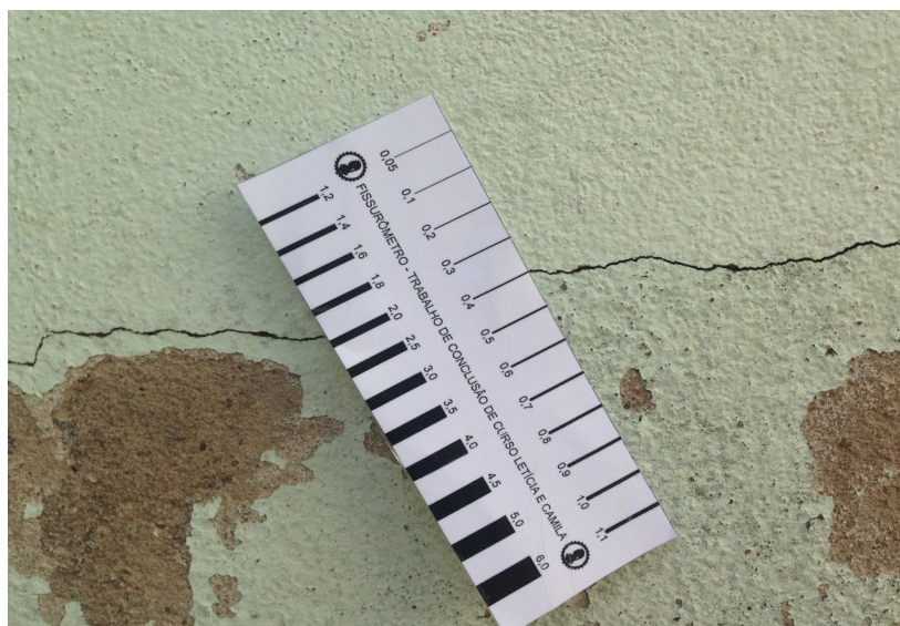
Figura 63: Vista aproximada da Fissura C.
