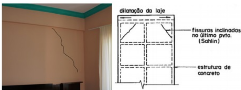
Figura 79: Fissura real (esquerda) e fissuração típica causada por movimentações térmicas (direita).
