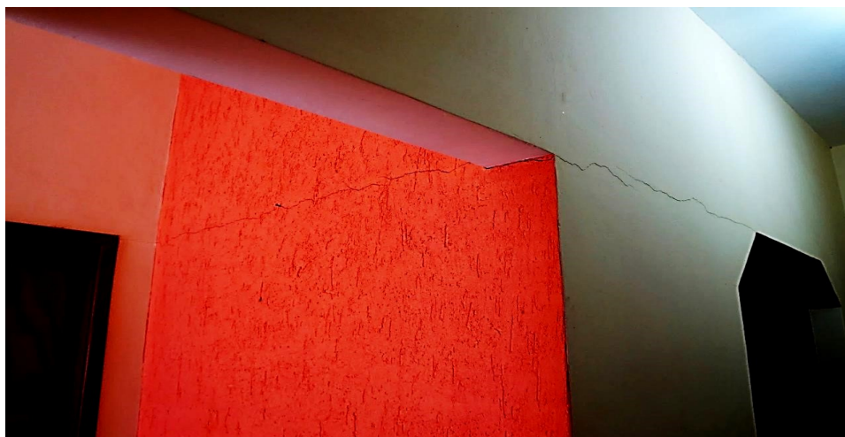
Figura 81: Vista da fissuração na parte externa, na ligação entre as paredes dos corredores.
