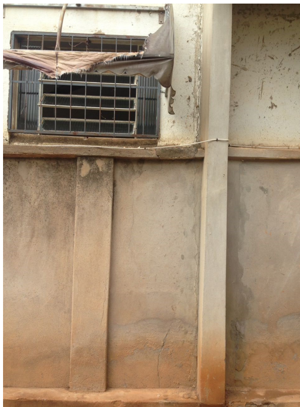
Figura 55: Vista geral da parte externa da parede onde se encontra a fissura.
