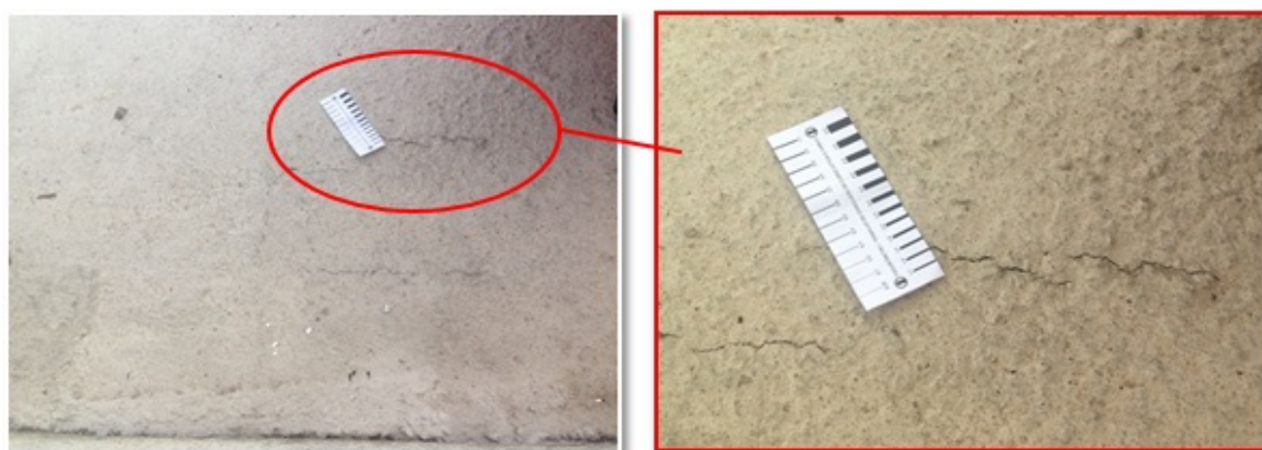
Figura 92: Vista aproximada da Fissura “N” na laje.
