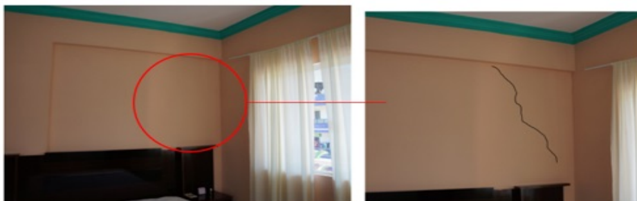
Figura 69: Vista da parte interna da parede do quarto, com fissura realçada com editor de imagens.
