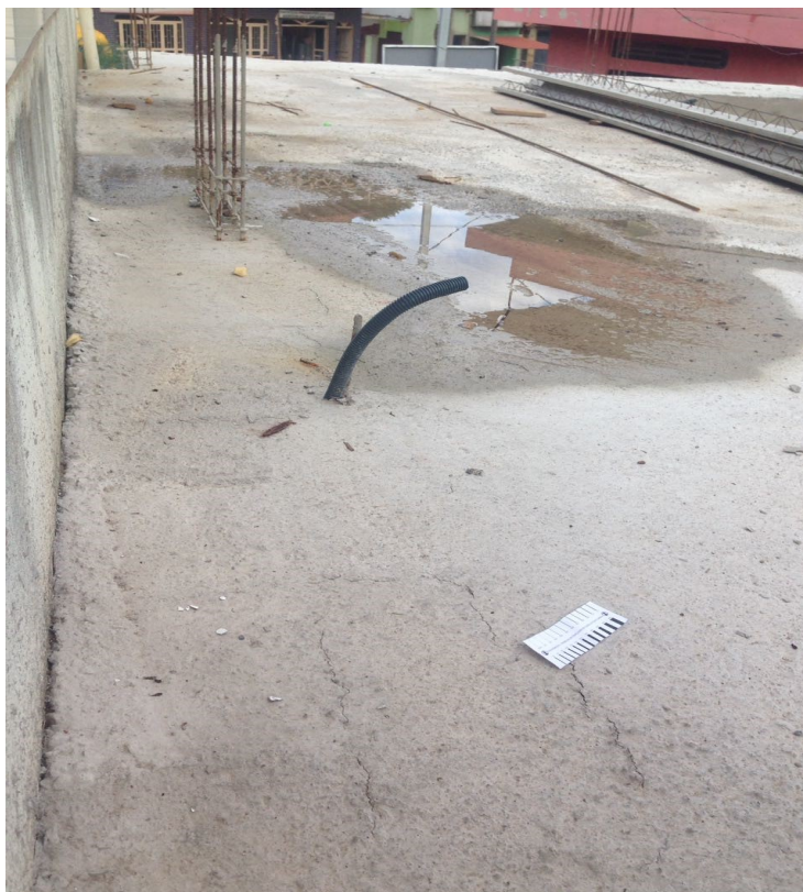
Figura 91: Vista geral da laje onde se encontra a Fissura N.
