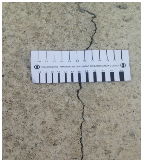
Figura 90: Vista aproximada da fissura M.
