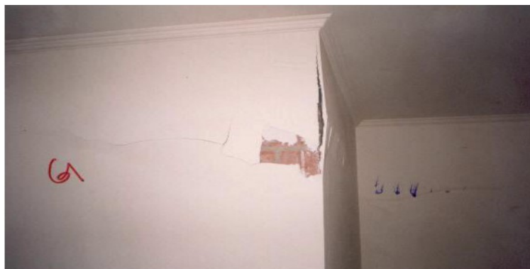
Figura 31: Destacamento do revestimento devido a movimentação higroscópica.
