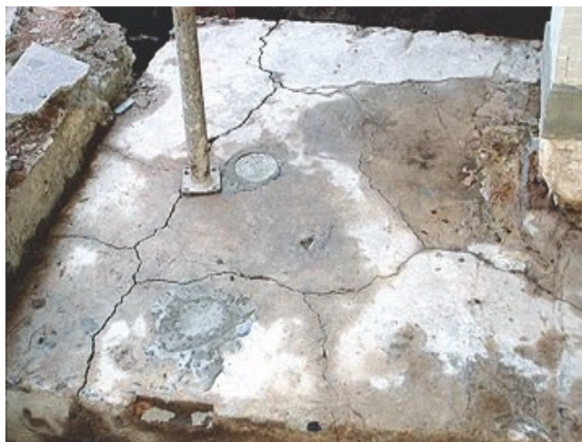
Figura 14: Fissuração em elemento estrutural causado por reação álcalis-agregado.
