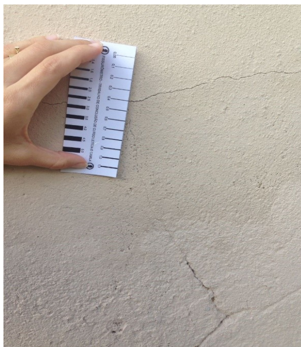
Figura 59: Vista aproximada da fissura B.
