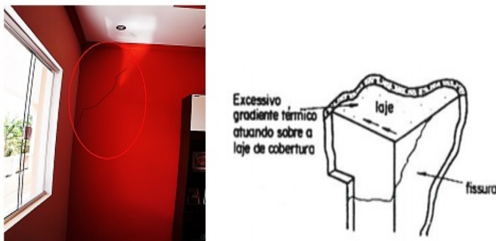
Figura 80: Figura 3.26: Fissura real (esquerda) e fissuração típica causada por movimentações térmica (direita).
