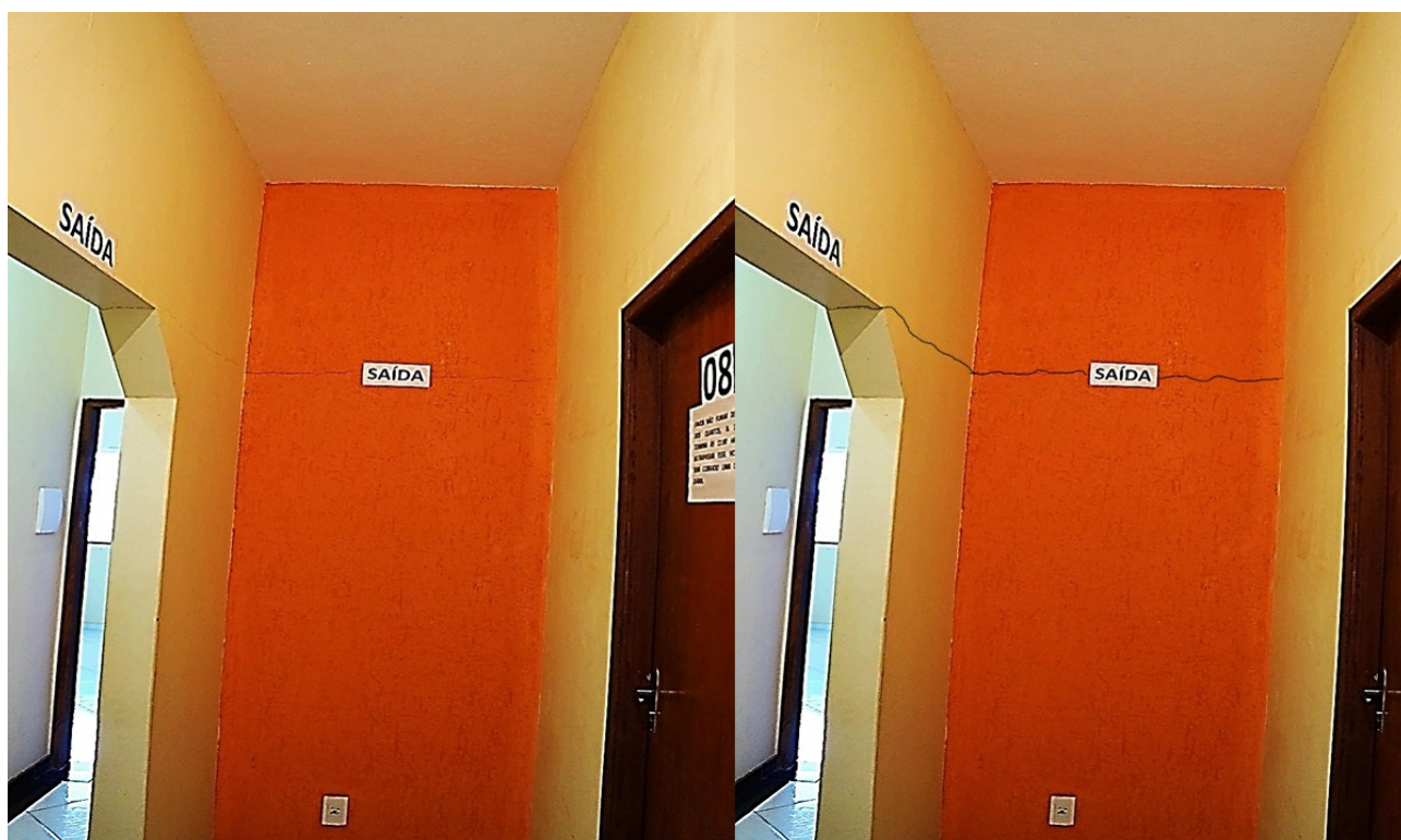
Figura 82: Vista da continuação da fissura na parte interna da ligação entre as paredes dos corredores, realçada com editor de imagens.
