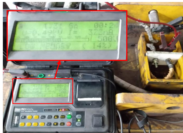
Figura 10 – Medição da Resistência de Isolamento 1,31GΩ
