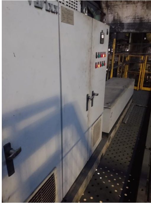
Figura 3 – Painel elétrico de acionamento
