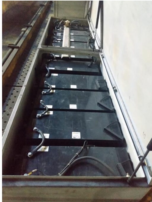
Figura 4 – Banco de baterias
