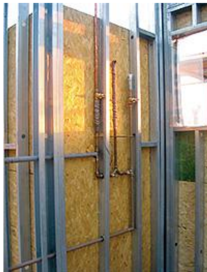
Figura 22: Instalação hidráulica com tubulações de cobre e de PVC
