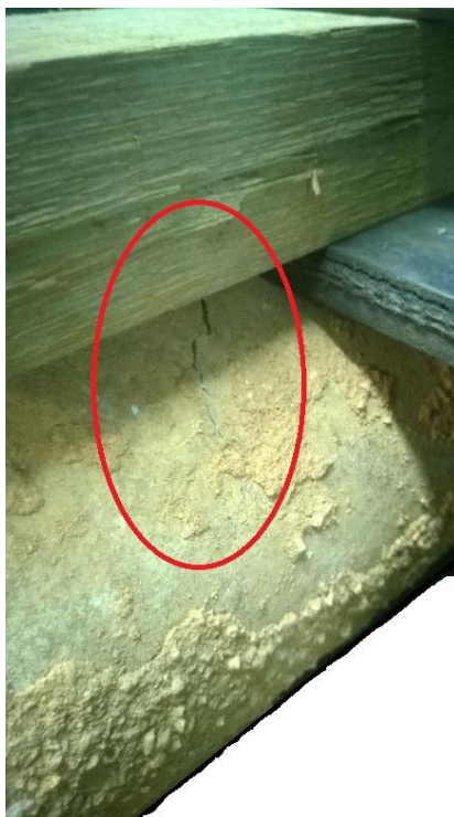
Figura 11: Primeiras fissuras notadas no tubo de fibrocimento. Fonte: Arquivo Pessoal.
