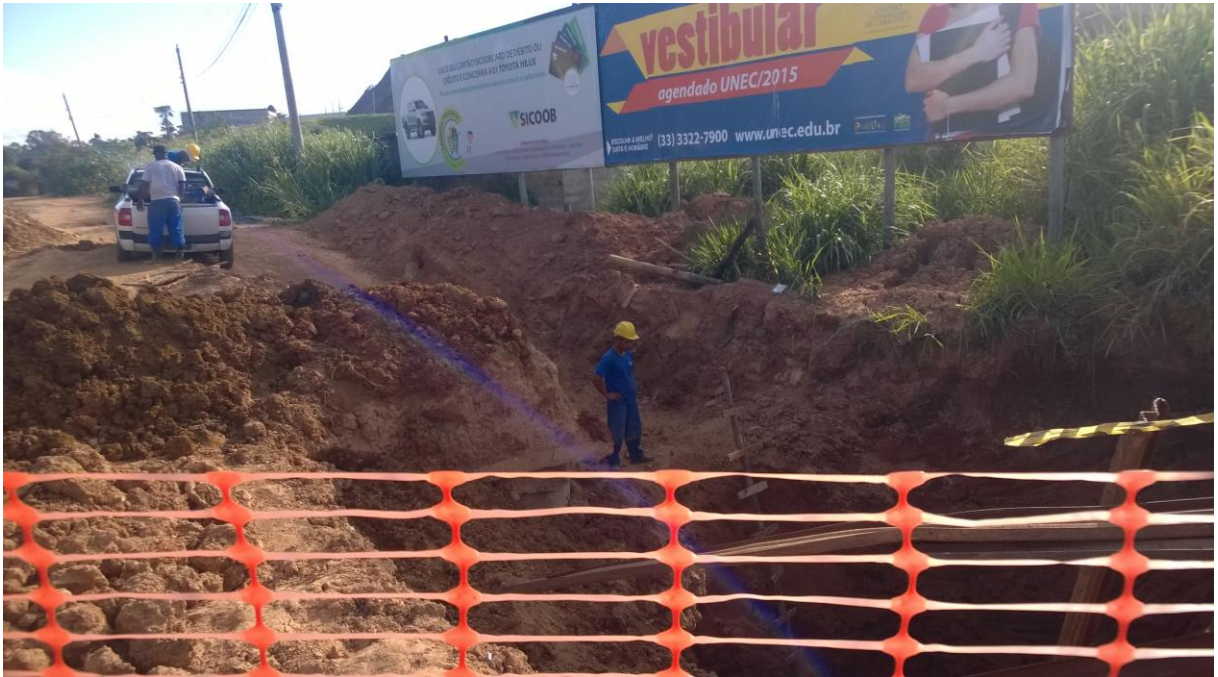
Foto 3 – Cratera ocasionada pelo rompimento.
