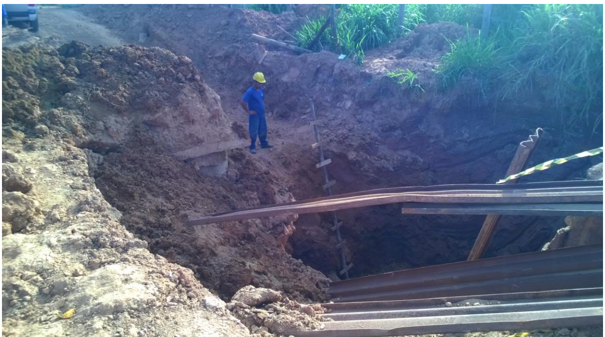
Foto 2 – Cratera ocasionada devido o rompimento da rede.
