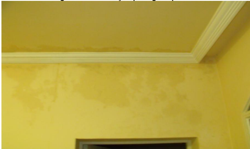
Figura 06 – Infiltração por águas pluviais
