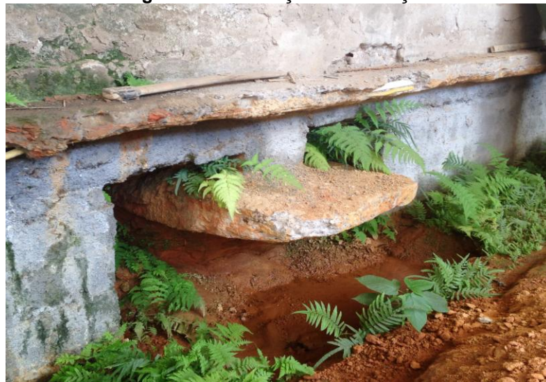
Figura 10 – Fundação em correção
