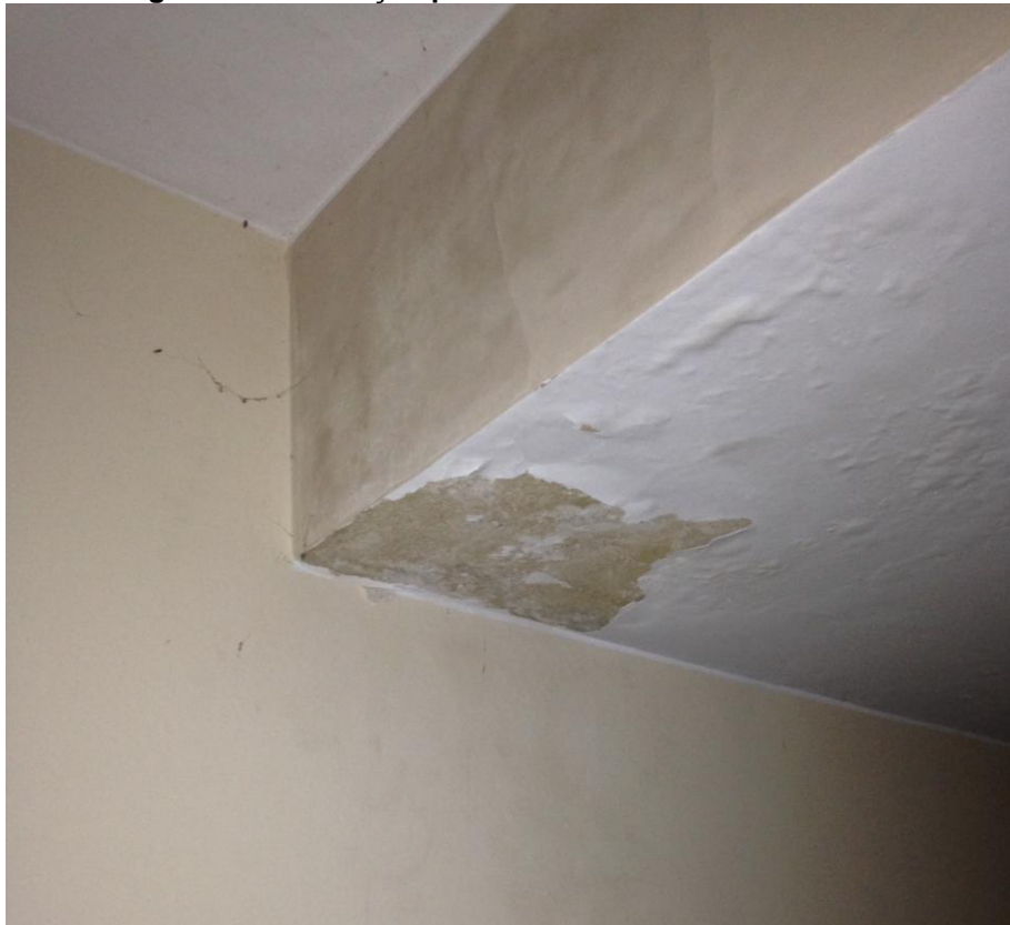
Figura 08 – Infiltração por vazamento na rede hidráulica
