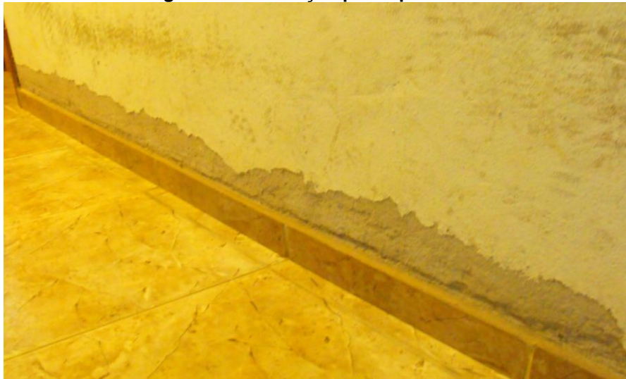
Figura 04 – Infiltração por capilaridade
