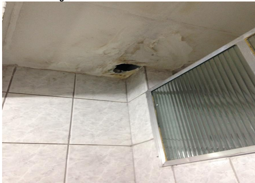
Figura 16 – Forro do banheiro danificado
