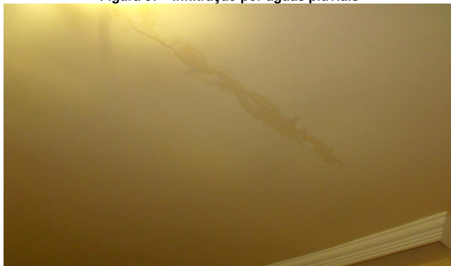
Figura 07 – Infiltração por águas pluviais
