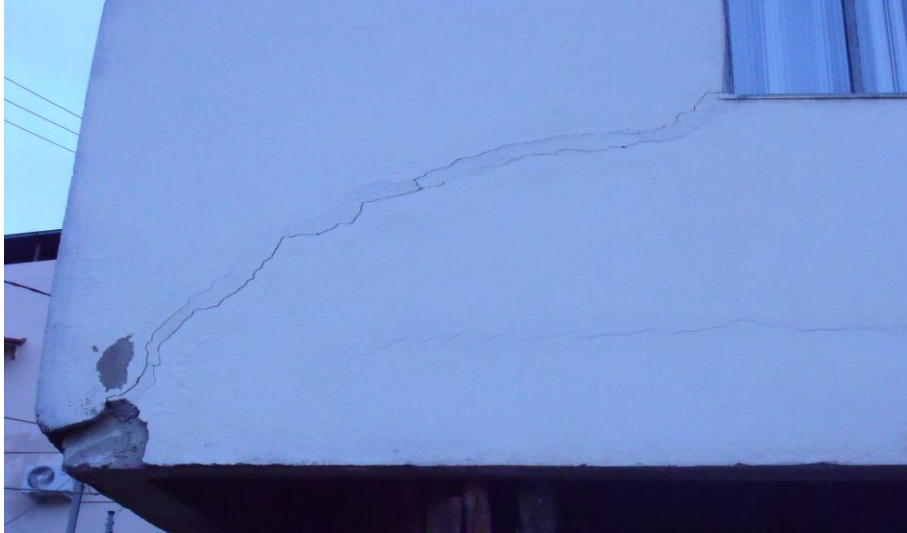
Figura 07 – Trinca na fachada do edifício
