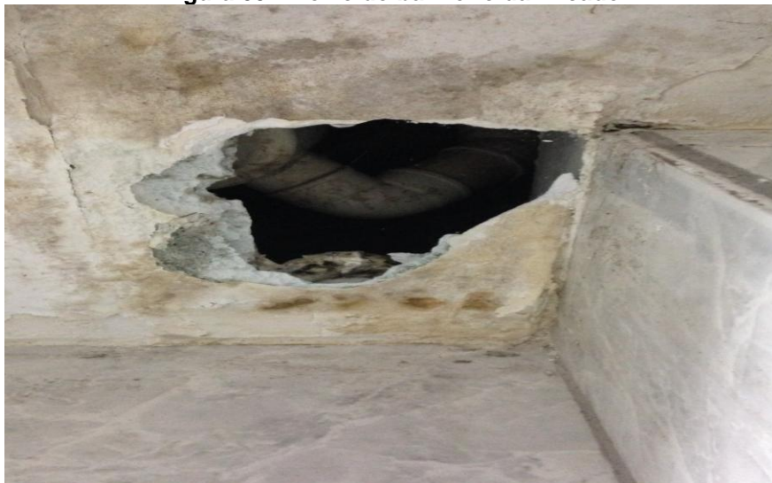
Figura 09 – Forro do banheiro danificado
