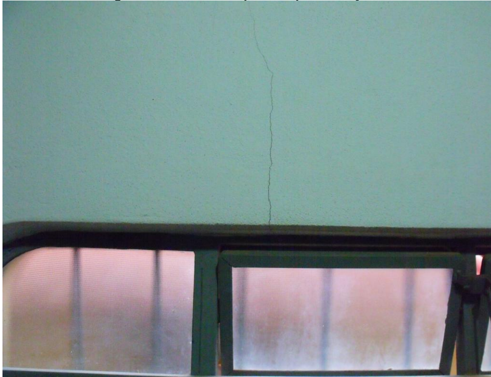
Figura 12 – Fissura na parte superior da janela
