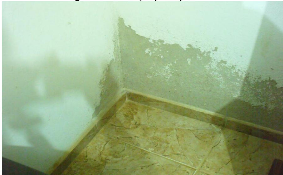
Figura 05 – Infiltração por capilaridade
