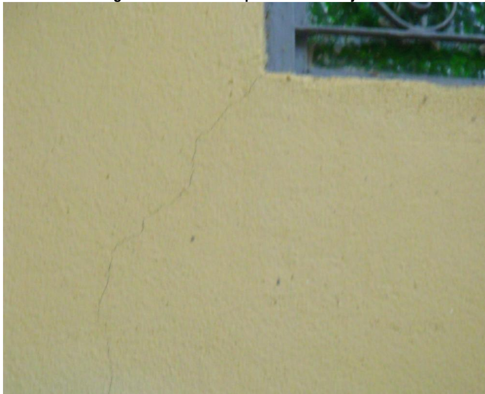
Figura 11 – Fissura na parte inferior da janela
