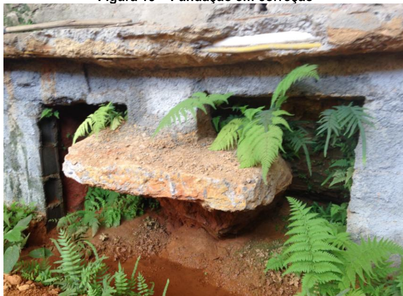
Figura 19 – Fundação em correção
