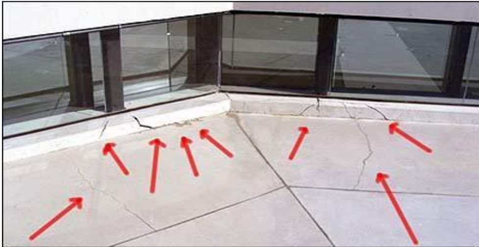
Figura-08 Trincas na Sacada
