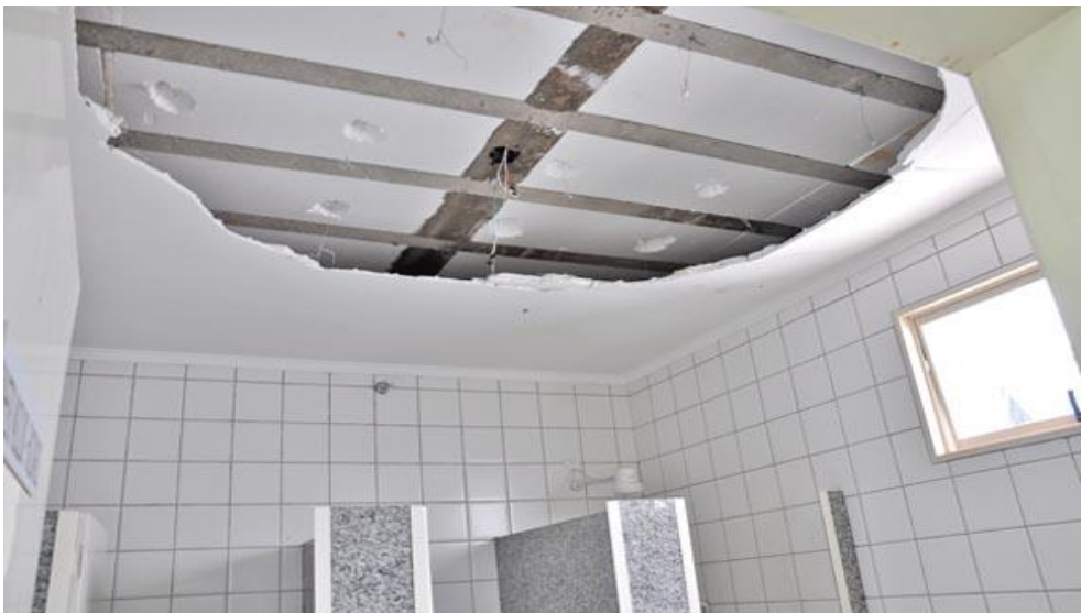
Figura-09 Queda de Forro de Gesso
