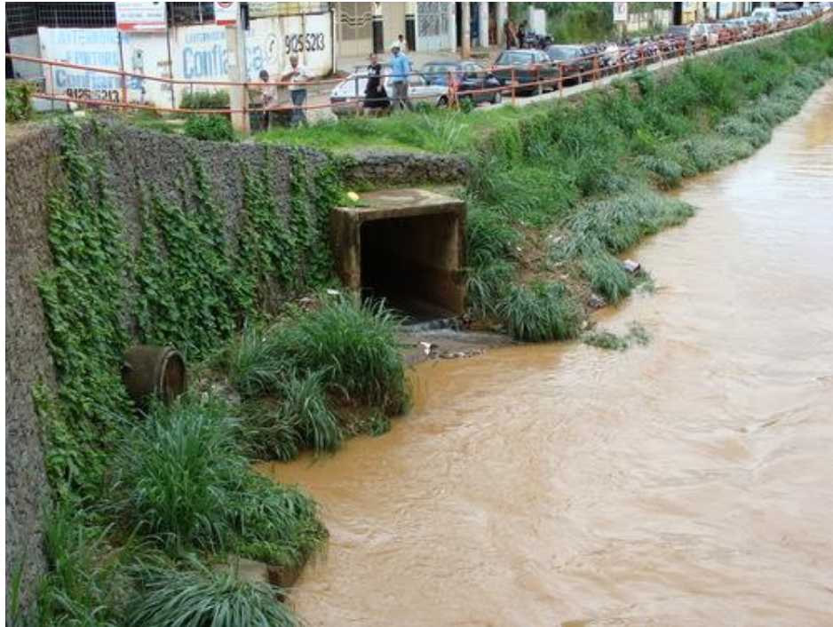
Figura 6: Lançamento de esgoto direto no rio
