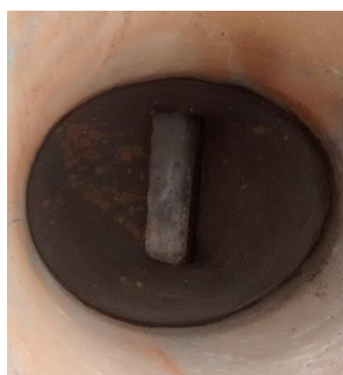
Figura 61 - Vista interior de poço de visita com balão. Fonte: Acervo dos autores.
