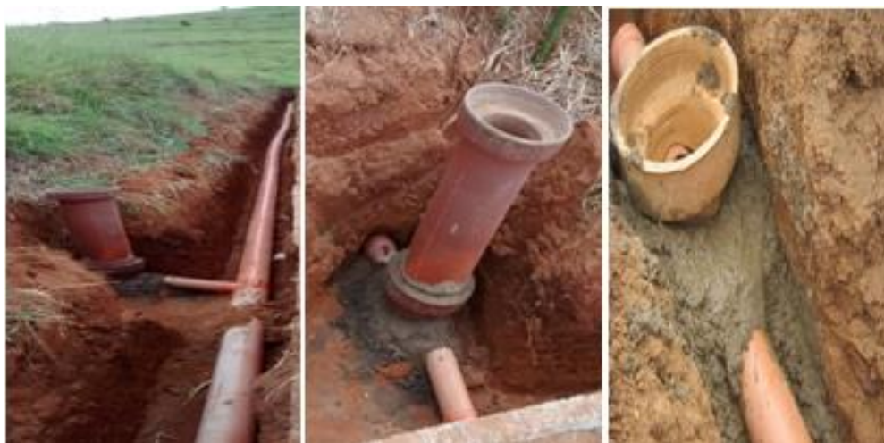
Figura 77 - Cronologia de Instalação de tubo cerâmico na rede predial. Fonte: Acervo dos autores.
