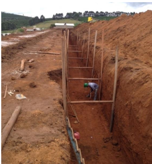
Figura 36 - Nivelamento de rede com escoramento tipo pontaleamento com fio de náilon para o assentamento da tubulação.
