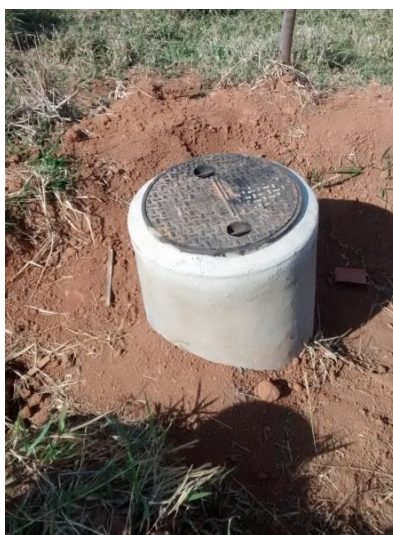
Figura 65 - Poços de Visita em loteamento com tampão de ferro fundido. Fonte: Acervo dos autores.
