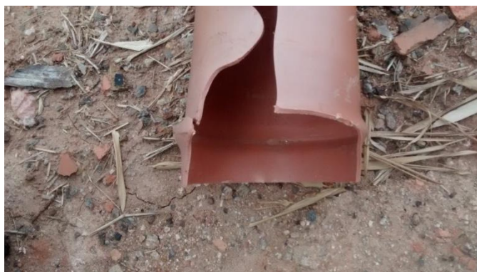
Figura 14 - Manuseio incorreto (corte da tubulação) de tubo de esgotamento sanitário. Fonte: Acervo dos autores.
