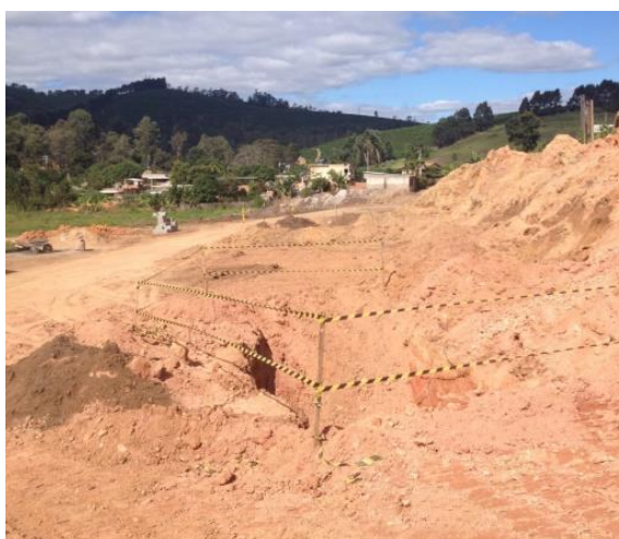
Figura 20 - Sinalização da rede coletora em um loteamento.
