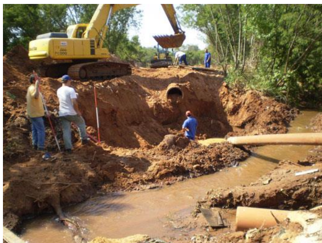
Figura 03 - Interceptor no córrego da água da Forquilha. Fonte: DAE. 2014.
