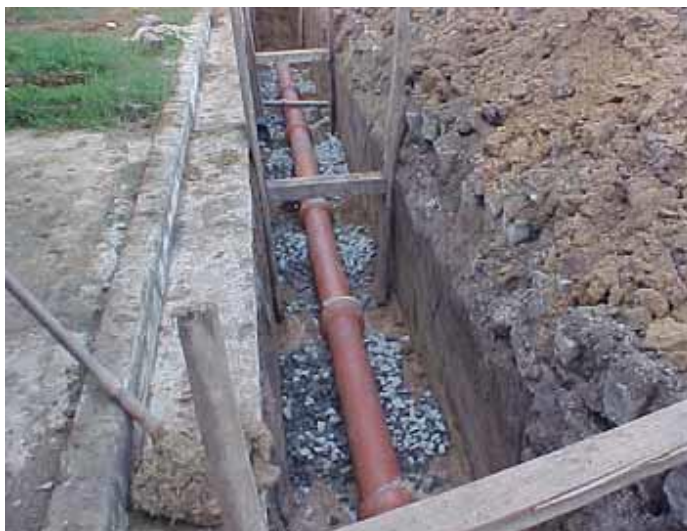
Figura 02 - Rede coletora principal. Fonte: SABESP, 2014.
