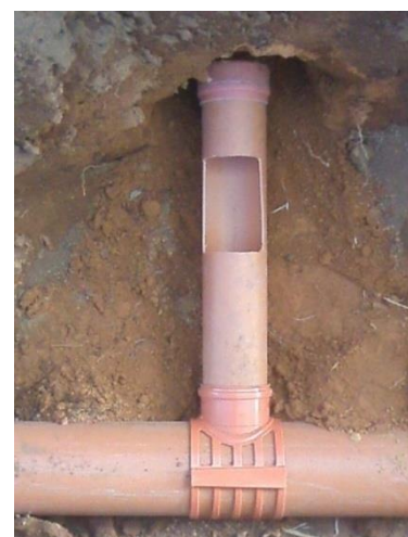
Figura 76 - Instalação sanitária de um poço luminar em um loteamento.
