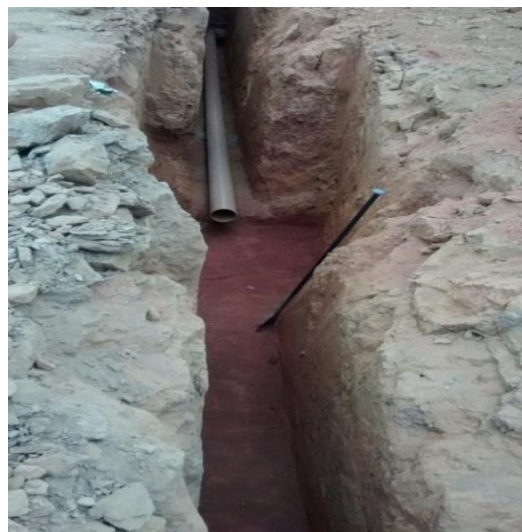
Figura 55 - Berço já compactado, posicionando-se a tubulação a montante para execução. Fonte: Acervo dos autores.
