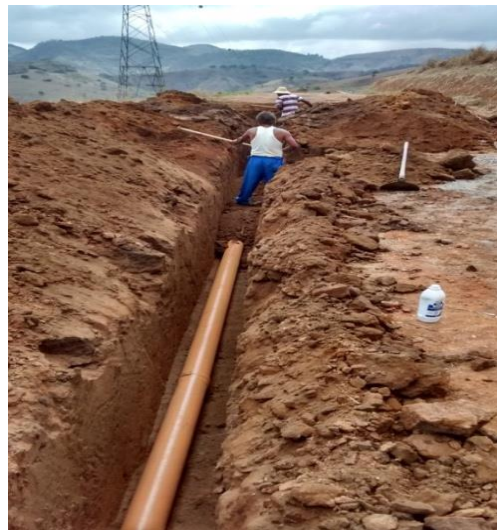
Figura 80 - Reaterro da tubulação de esgotamento e compactação manual em rede de loteamento. Fonte: Acervo dos autores.
