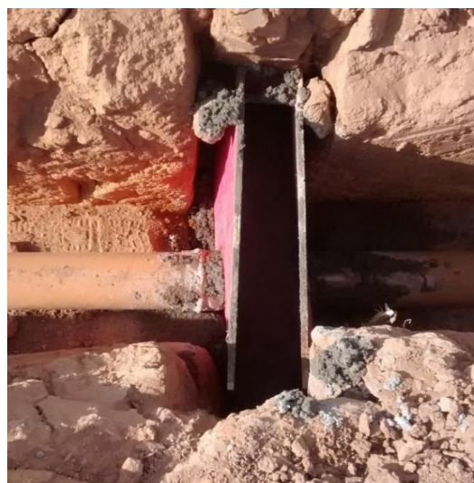
Figura 50 - Posicionamento das armaduras nas fôrmas para a concretagem das ancoragens. Fonte: Acervo dos autores.
