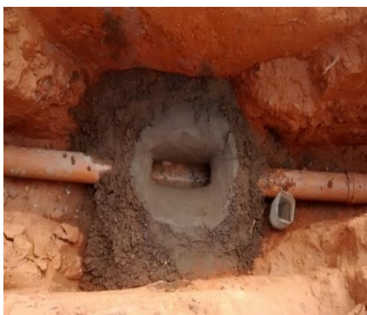
Figura 57 - Poços de Visita in loco com passagem reta. Fonte: Acervo dos autores.
