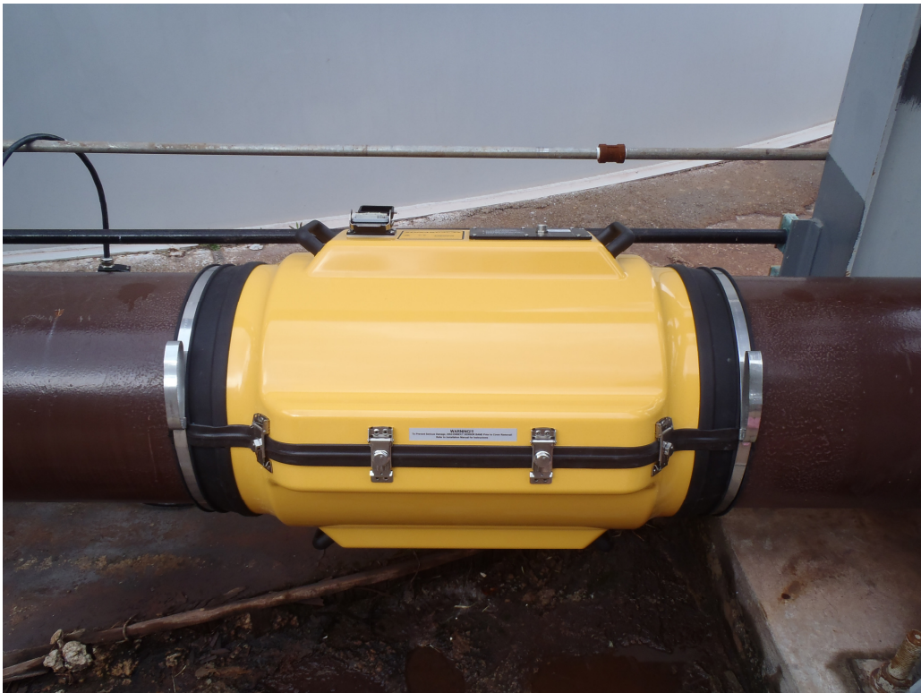
Figura 14: SonarTrac instalado na Tubulação (Fonte: Samarco Mineração)
