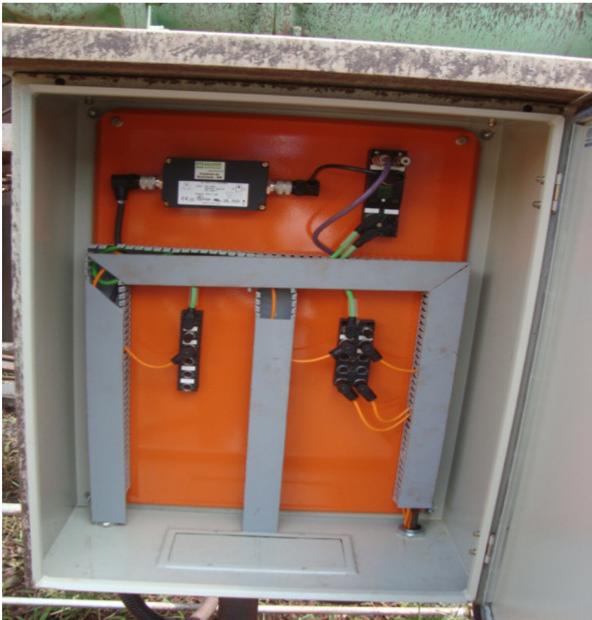
Figura 8: Foto de um painel profibus completo (Fonte: Samarco Mineração)
