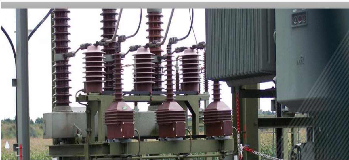
Figura 22 – Vista Geral de um grupo de transformadores instalados em um sítio protegido
