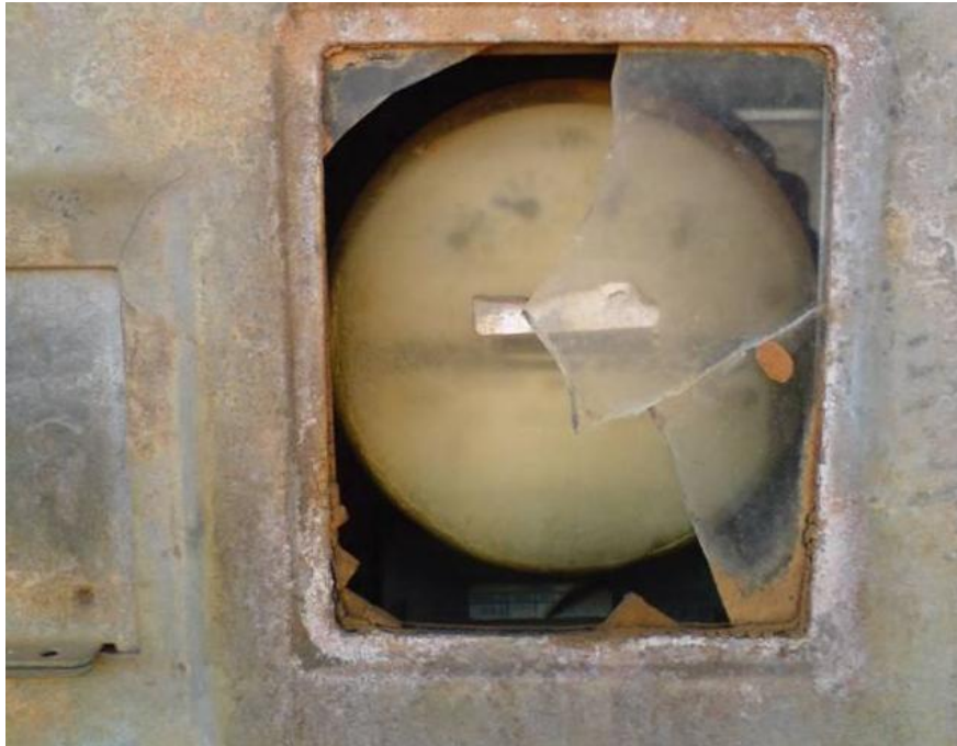
Figura 11: Medidor danificado Fonte: Cemig 2 - Análise do Risco da Unidade Consumidora (2011)
