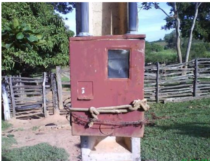
Figura 10: Exemplo de medidor danificado Fonte: Cemig 2 - Análise do Risco da Unidade Consumidora (2011)
