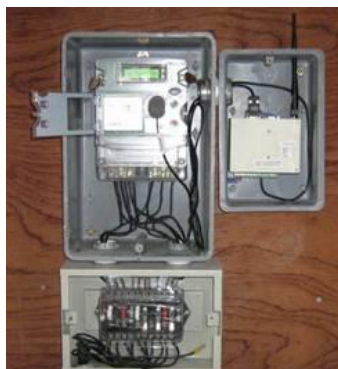
Figura 21: Conjunto de telemetria consumidores grupo A. Fonte: Teleco, 2010
