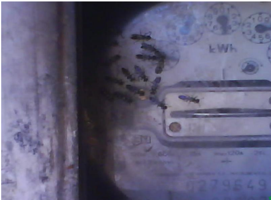
Figura 12: Exemplo de insetos dificultando e oferecendo riscos ao trabalho do agente de leitura .Fonte: Cemig 2 - Análise do Risco da Unidade Consumidora (2011)
