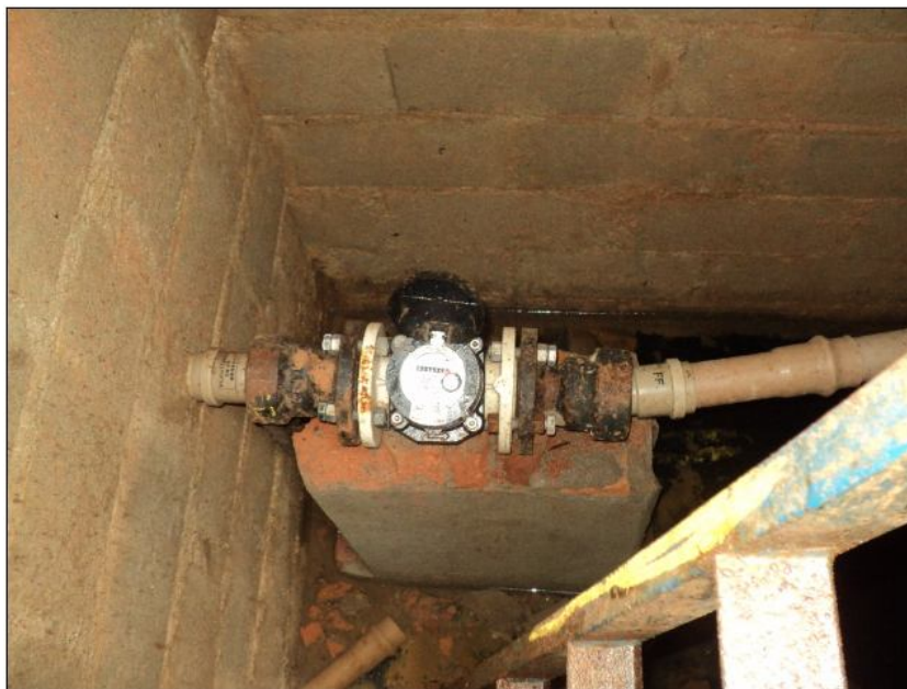
Figura 3.4 – Macromedidor DN 60 mm: Reservatório R-03
