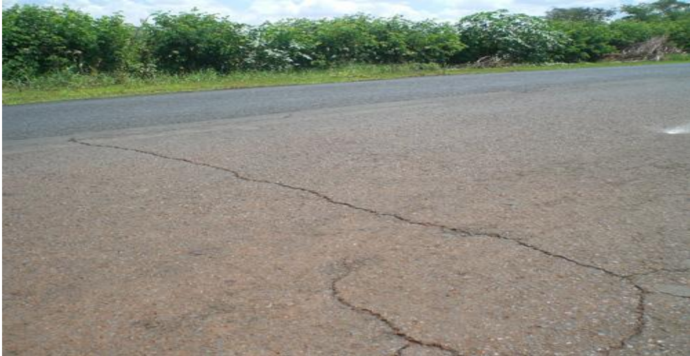
Figura 12. Trincas por fadiga.
