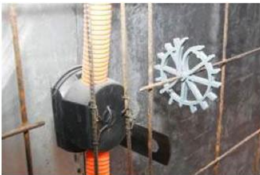
Figura 6 – Caixas de ponto de energia elétrica
