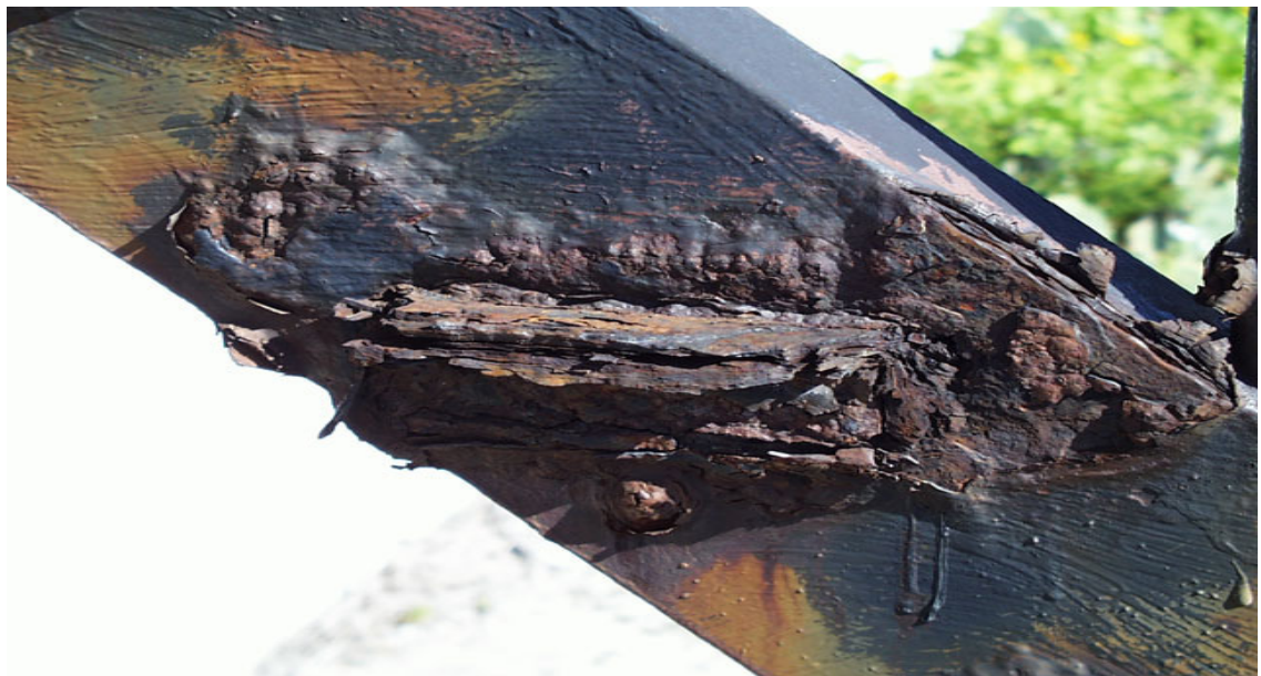
Figura 2 - Corrosão Localizada. Fonte: site Manutenção e Suprimentos
