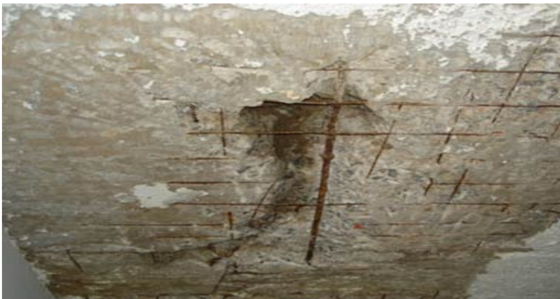
Figura 8 - Concreto mal vibrado. Fonte: site www.vidacivil.blogspot.com.br
