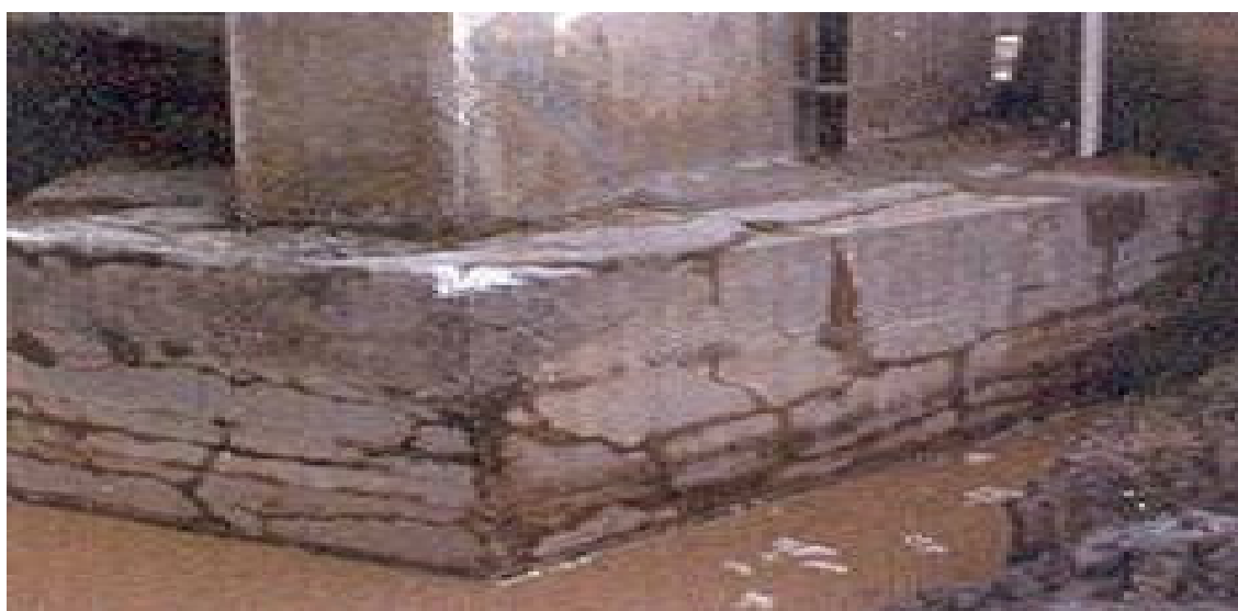
Figura 5 - Fissuração por Sobrecarga. Fonte: site www.sosimoveisbrasil.com.br
