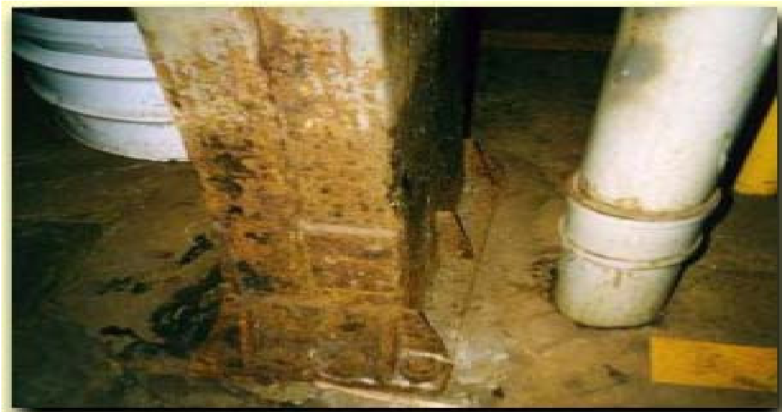
Figura 1 - Corrosão Uniforme. Fonte: Centro de Estudo de Engenharia Civil – Rio de Janeiro
