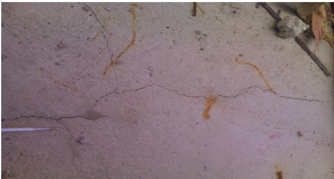
Figura 6 - Fissuração por Retração do Concreto. Fonte: site http://www.consultoriaeanalise.com
