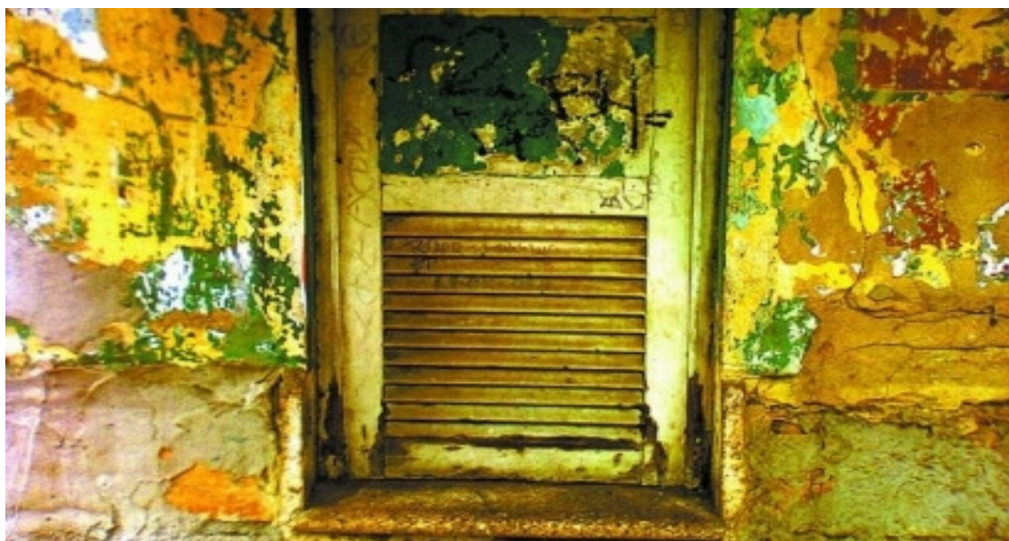
Figura 9 - Desgaste Superficial do Concreto. Fonte: site http://www.diarioonline.com.br
