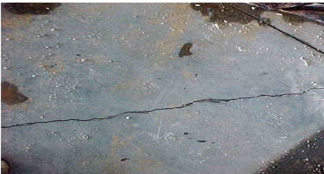
Figura 7 - Fissuração por Agentes Agressivos. Fonte: Revista Construção e Mercado
