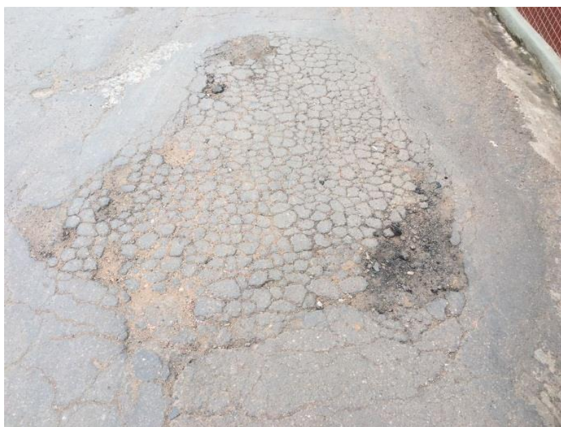
Figura 7. Trincas couro de jacaré.
