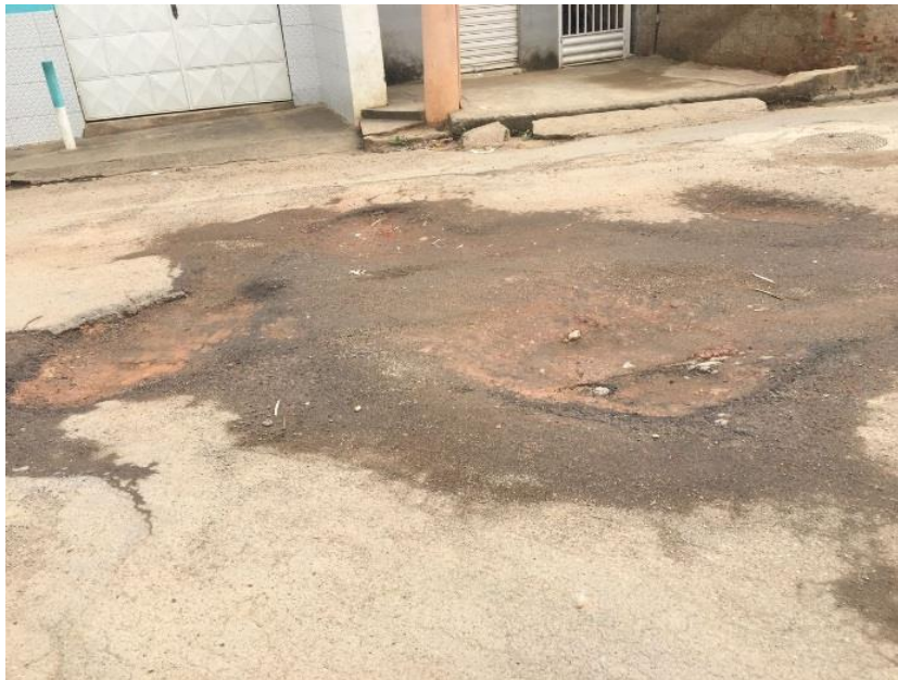
Figura 11. Panela atingindo a base comprometida com barro devido à água da chuva.
