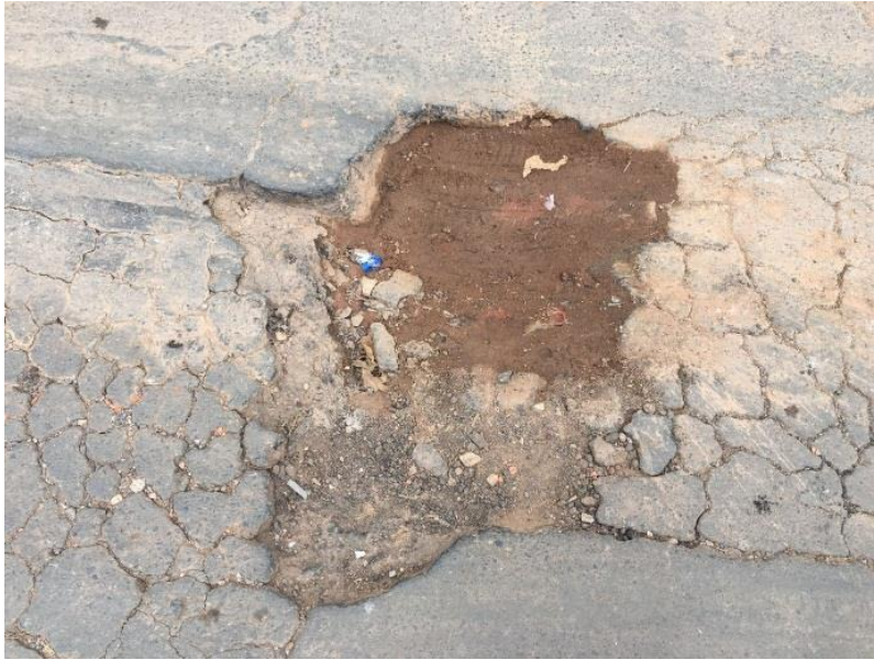
Figura 12. Panela atingindo a base com trincas de jacaré em volta.
