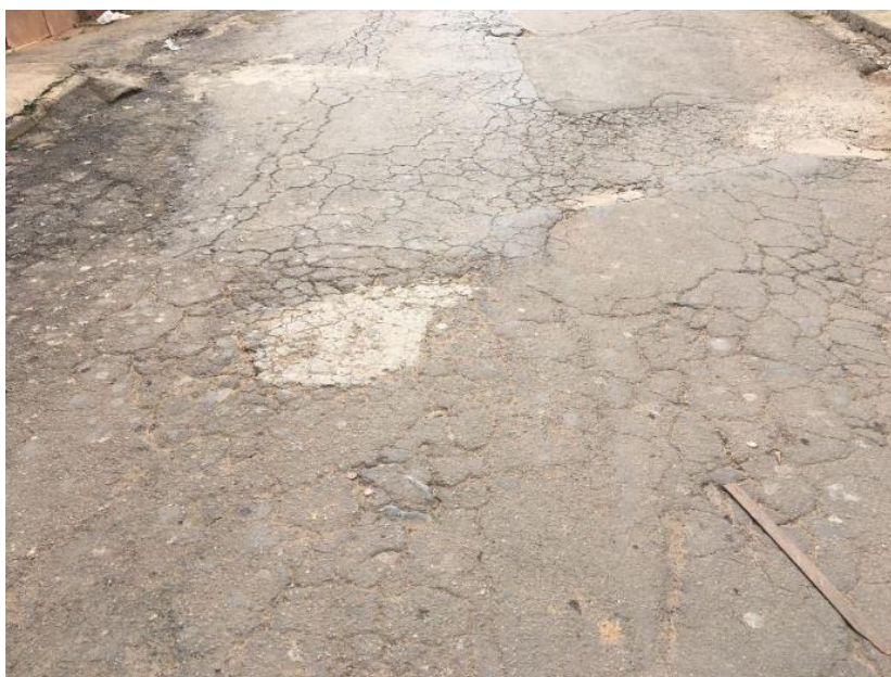
Figura 6. Trincas de bloco.
