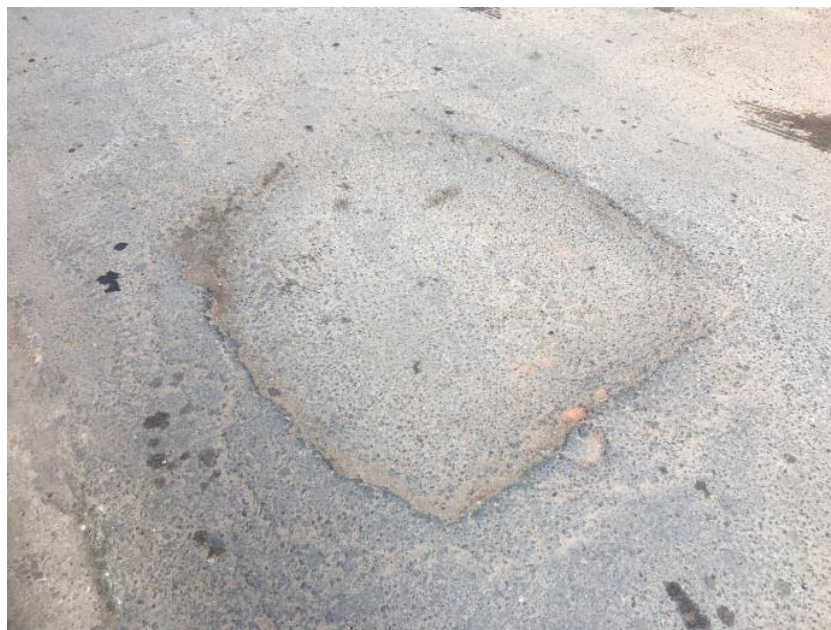
Figura 8. Afundamentos por consolidação.
