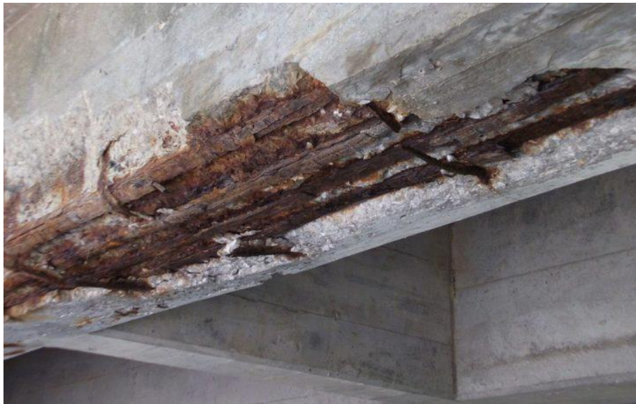
Figura 14 - Exemplo de Corrosão da Armadura em Viga
