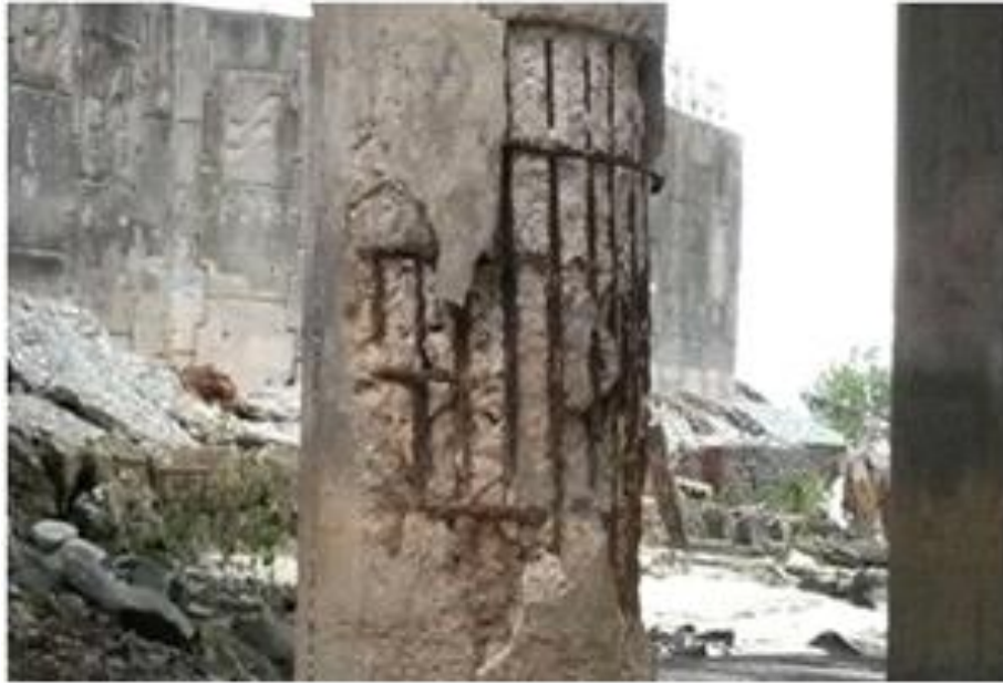
Figura 13 - Exemplo de Corrosão em Pilar
