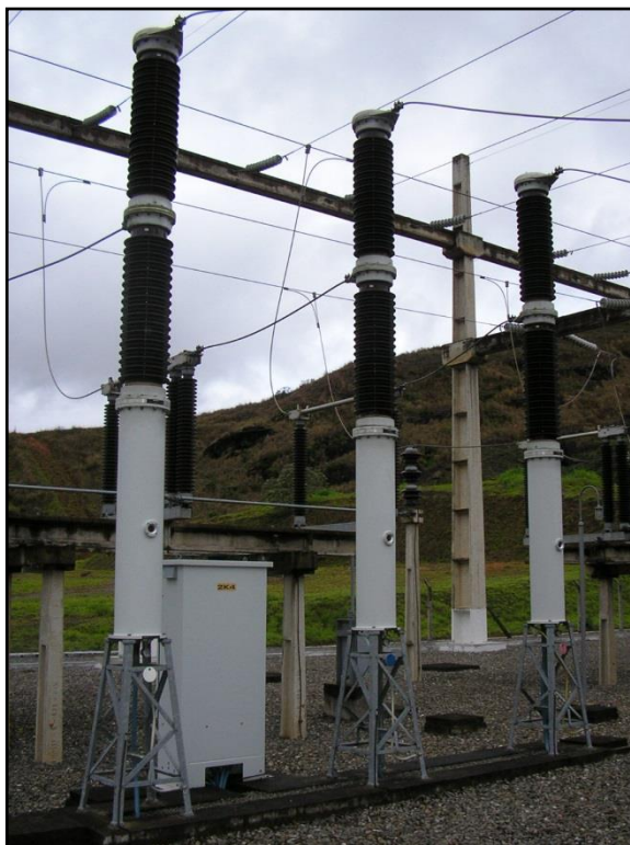
Figura 16 - Disjuntor monopolar 138 kV - SF 6
