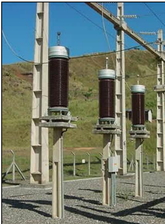
Figura 17 - Transformador de Potencial 138kV
