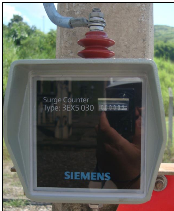
Figura 22 - Contador de descarga do para-raios de ZnO
