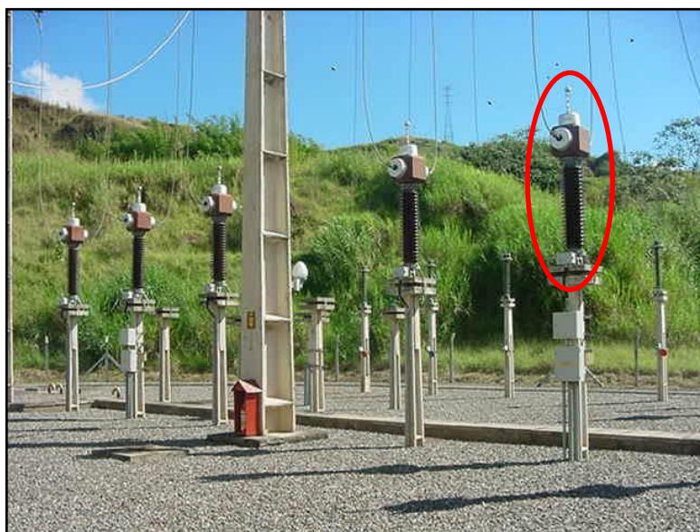
Figura 18 - Transformador de corrente 138 kV
