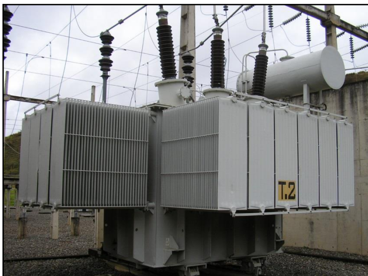
Figura 14 - Transformador de Potência com conservador a óleo
