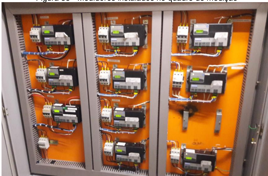
Figura 35 - Medidores instalados no quadro de medição
