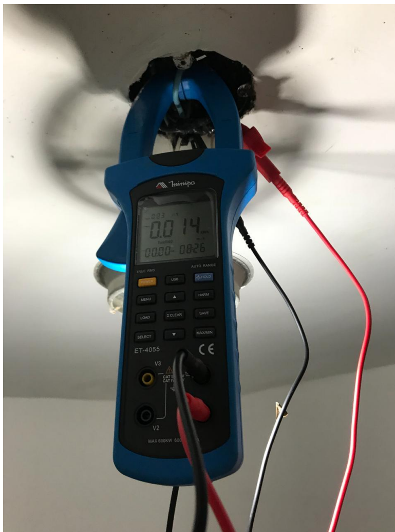
Figura 7 - Alicate Wattímetro instalado
