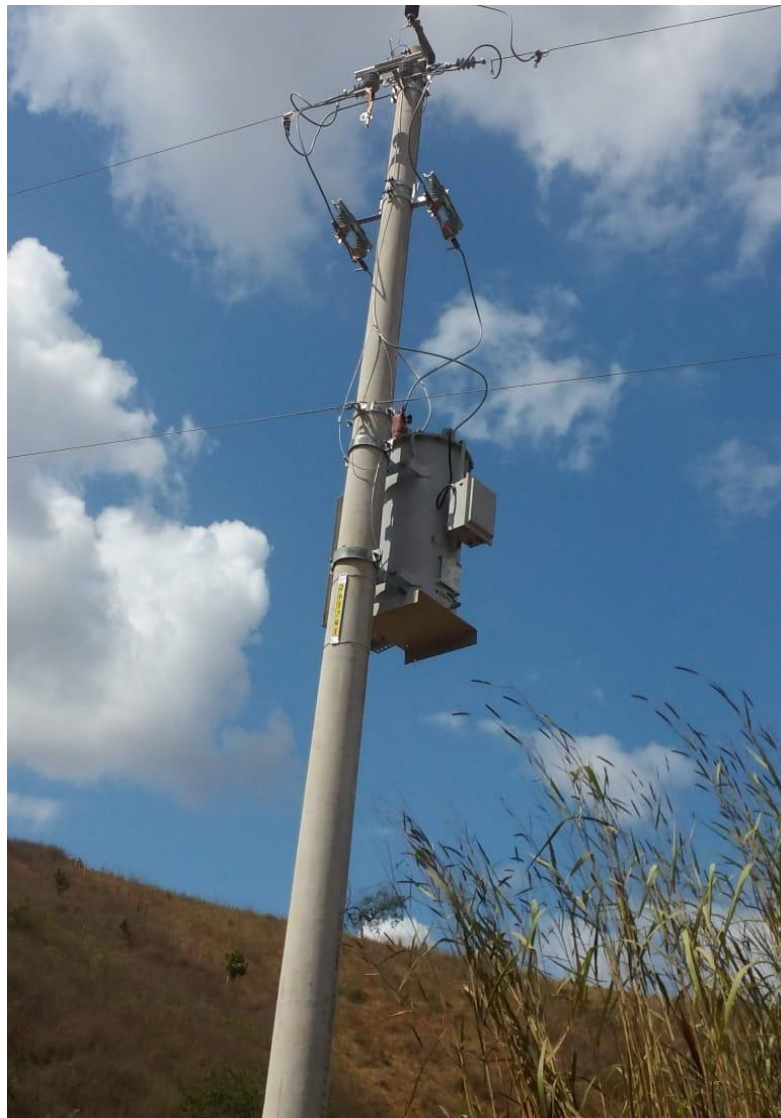
Figura 13 – Regulador de Tensão Instalado
