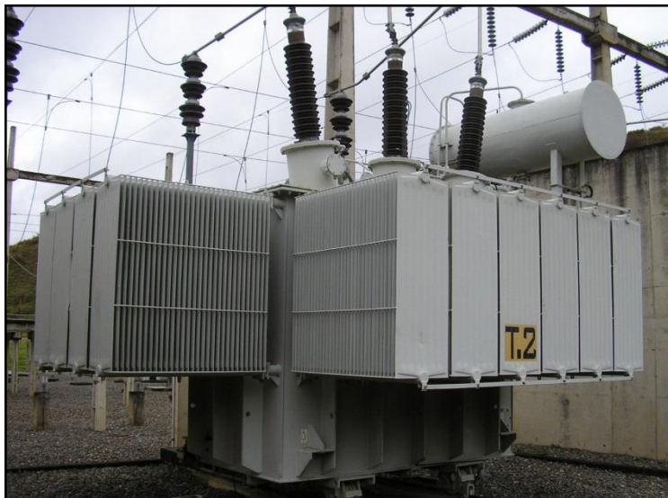
Figura 14 - Transformador de Potência com conservador a óleo
