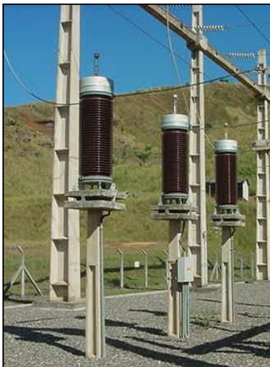
Figura 17 - Transformador de Potencial 138kV
