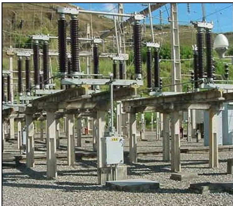
Figura 15 - Seccionadora tripolar 138kV
