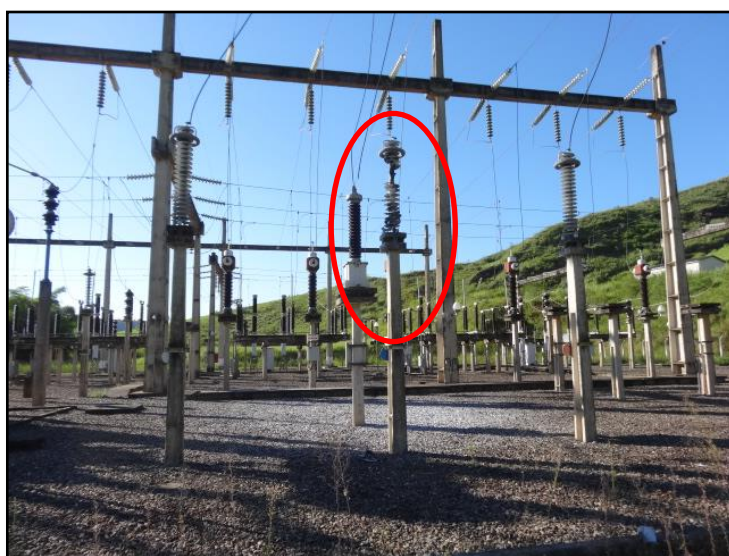
Figura 28 - Para-raios fase B da LT JFA danificado após ocorrência
