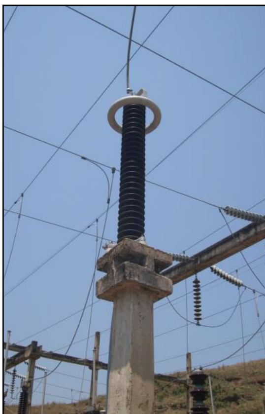
Figura 20 - Para-raios de óxido de zinco em corpo polimérico – SE 138 kV
