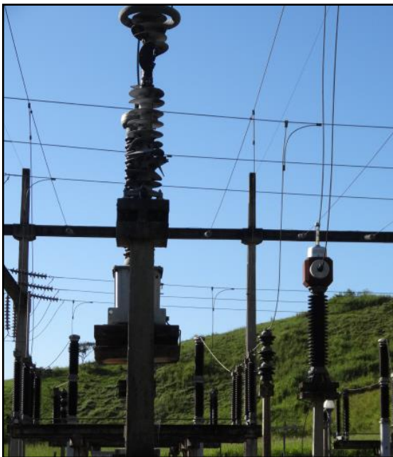
Figura 29 - Para-raios fase B da LT JFA danificado após ocorrência
