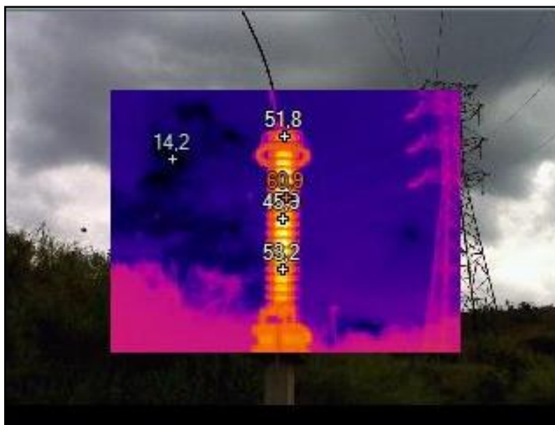
Figura 37 - Termograma do para-raios de ZnO fase B - Subestação Volta do Rio
