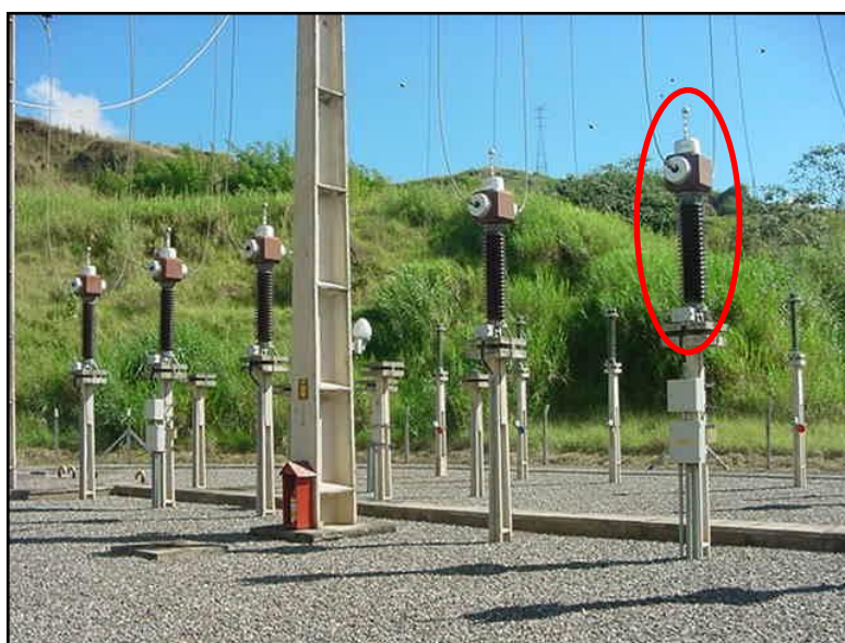
Figura 18 - Transformador de corrente 138 kV
