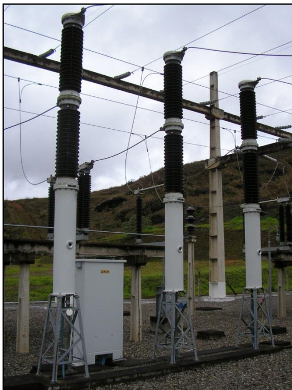
Figura 16 - Disjuntor monopolar 138 kV - SF 6
