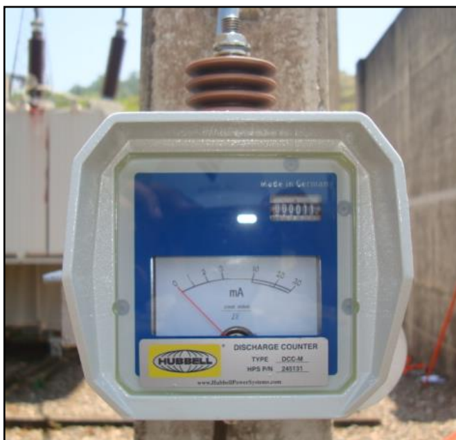
Figura 23 - Miliamperímetro e contador de descarga do para-raios de ZnO
