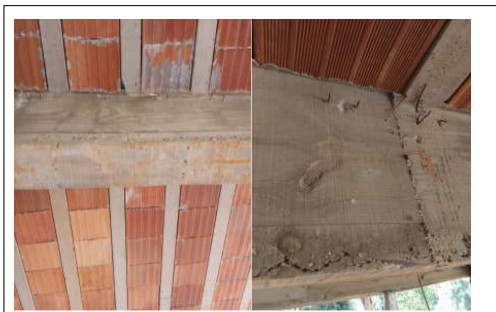
Figura 3: Patologias encontradas na viga de caso de estudo.
