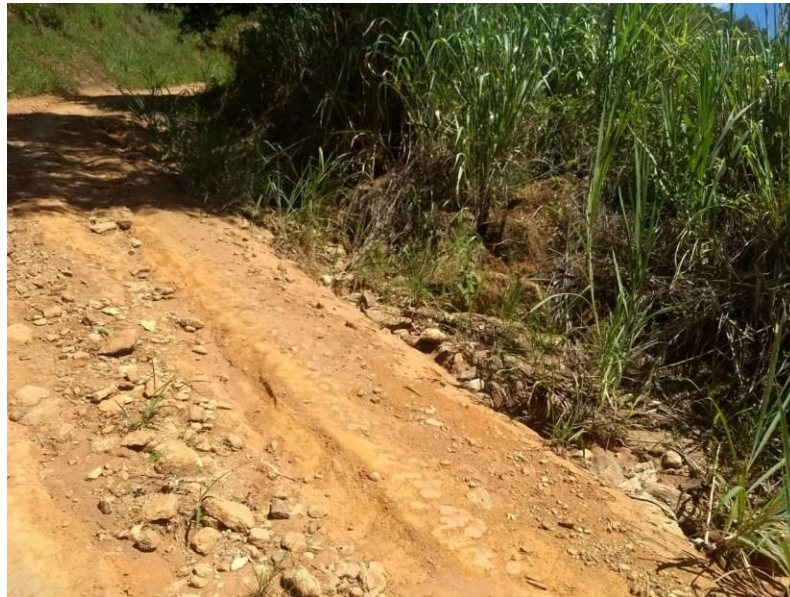
Figura 1 Plataforma sem abaulamento e sistemas de drenagem obstruídos
