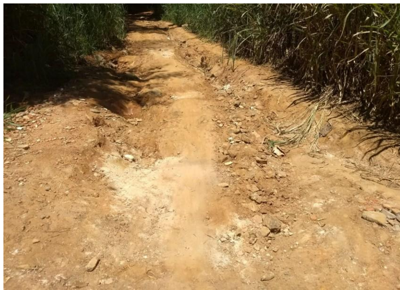
Figura 2 Plataforma sem sistemas de drenagem e abaulamento.
