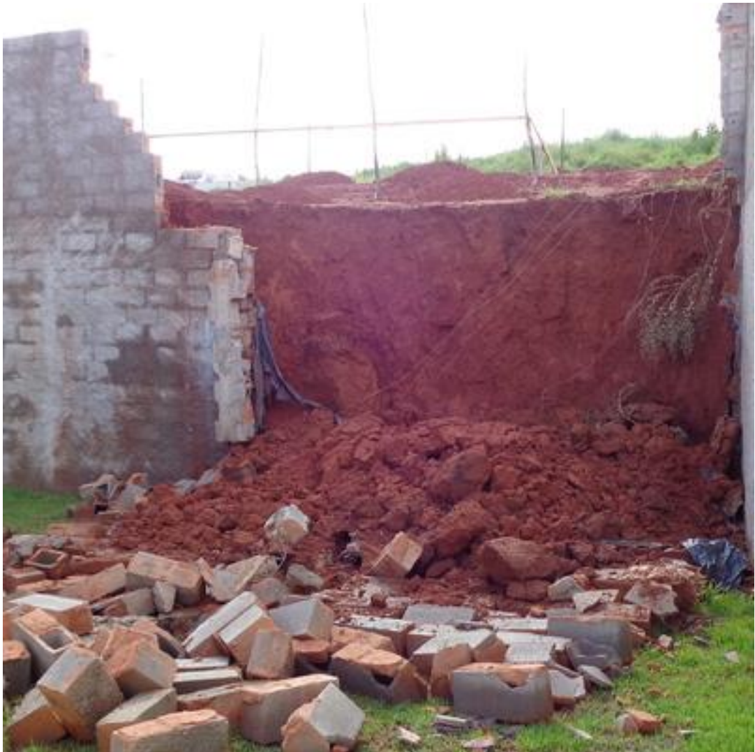
Figura 1: Muro que caiu parcialmente no município de Machado-MG
