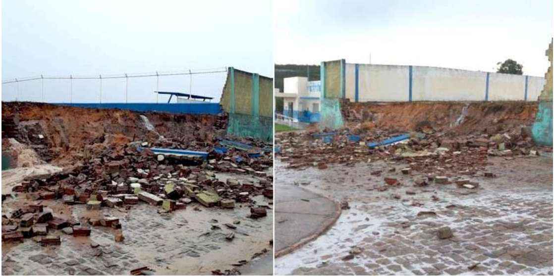
Figura 2: Muro de alvenaria estrutural que caiu na cidade de Barra da Estiva-BA
