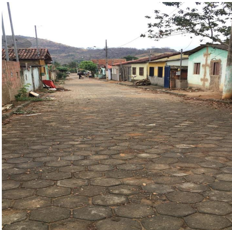
Figura 10 – Rua sem bueiros e bocas de lobo
