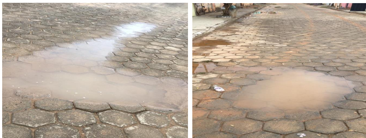
Figura 9 – Pontos de alagamento na Rua Sebastião Jose da Gama
