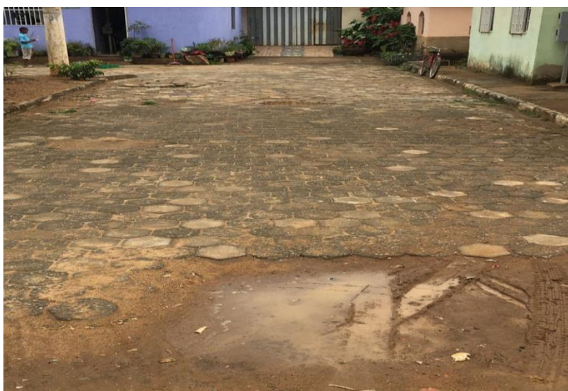
Figura 8 – Falta de infraestrutura
