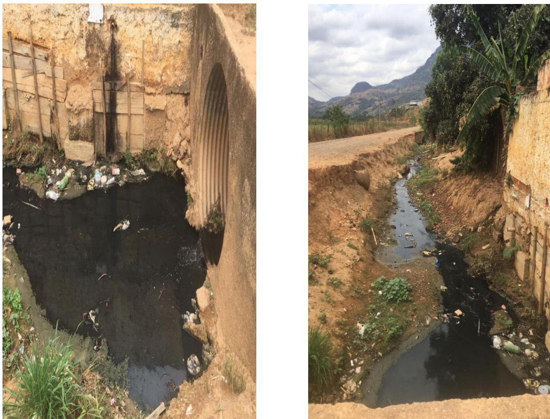
Figura 12 – Esgoto lançado a céu aberto no “valão”.
