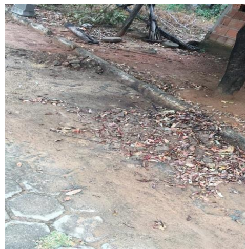
Figura 17 – Sarjeta com entulhos
