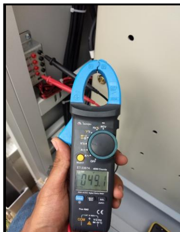
Figura 10: Tensão de saída dos retificadores
