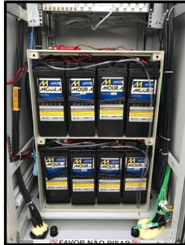
Figura 1: Banco de baterias.
