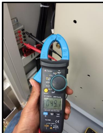
Figura 10: Tensão de saída dos retificadores
