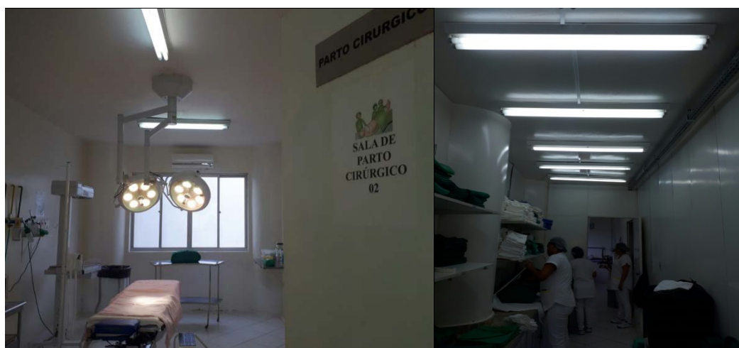
a) Sala de operação
