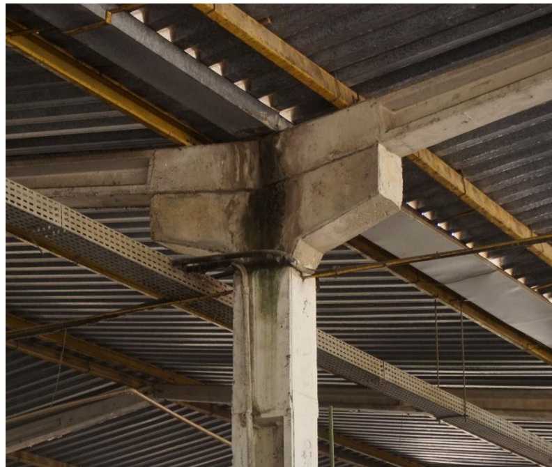
Figura 24: Infiltração vigas, arquivo autoral, 15/11/2019 às 15:03.
