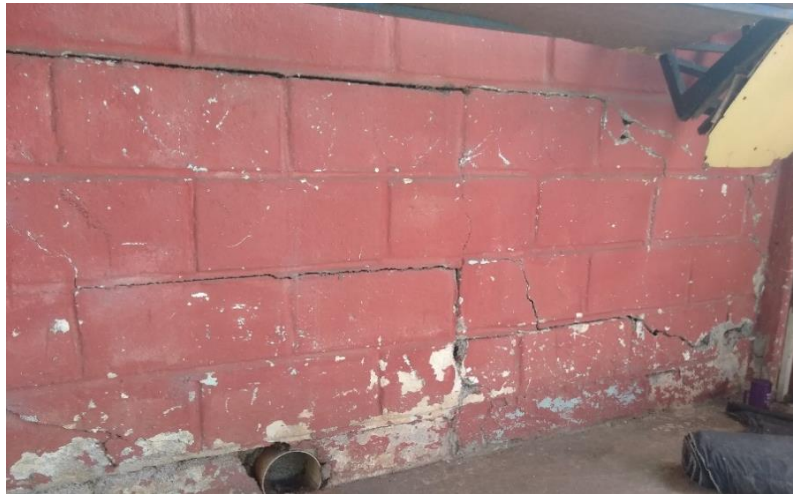
Figura 23: Trincas blocos de fechamento galpão, arquivo autoral, 15/11/2019 às 14:55.
