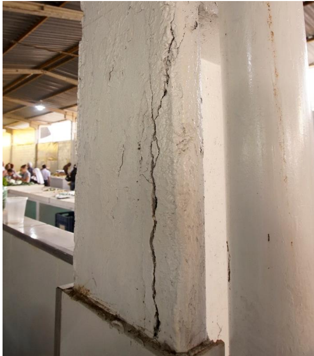
Figura 25: Fissura pilares, arquivo autoral, 16/11/2019 às 10:43.
