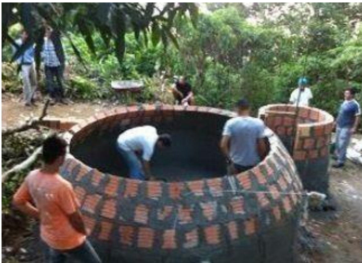
Figura 10 - Assentamento dos tijolos do biodigestor na comunidade Portelinha do Rio de Janeiro/RJ.
