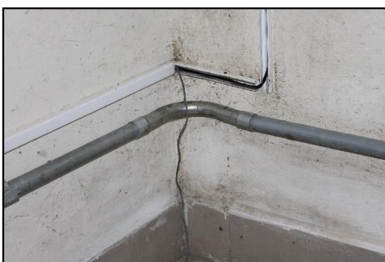
Figura 31: Umidade na parte inferior da parede
