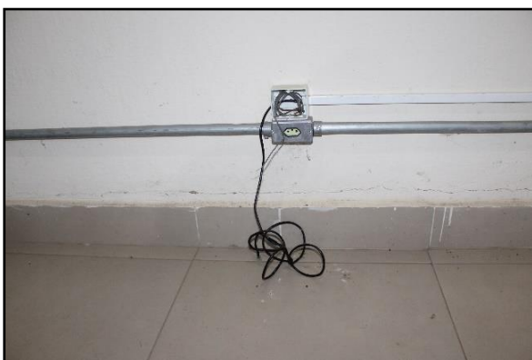
Figura 35: Ponto elétrico obstruído
