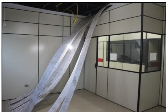
Figura 34: Ponto de iluminação do teto
