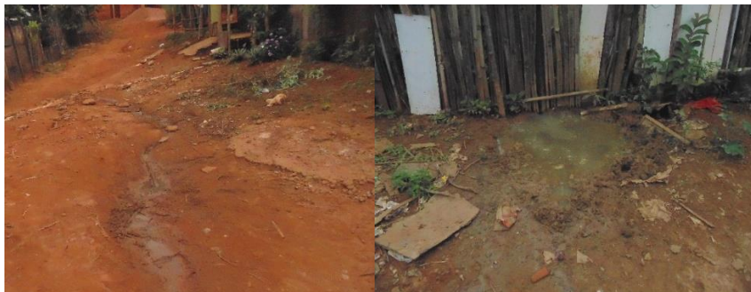
Figura 40 Esgoto a céu aberto
