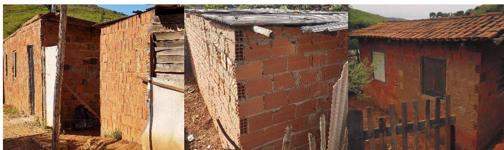
Figura 42 Imagens das casas com as paredes próximas ao chão
