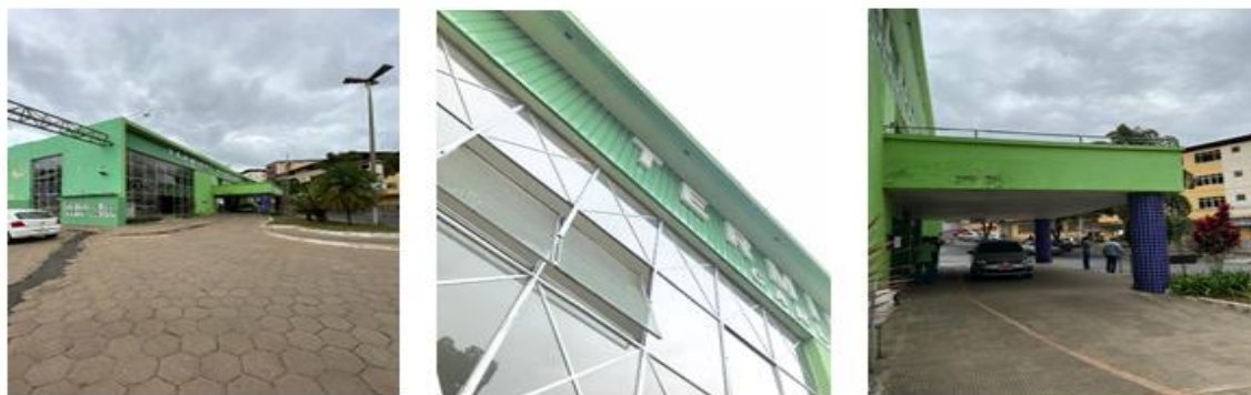
Figura 63– Fachada com pontos de infiltração e ausência de iluminação
