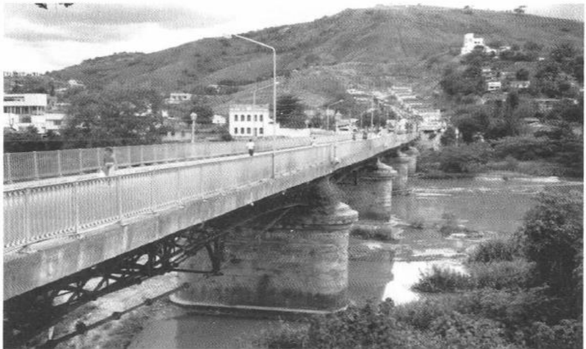
Figura 2 - Ponte sobre o rio Paraíba do Sul, Estado do Rio de Janeiro. Vista geral
