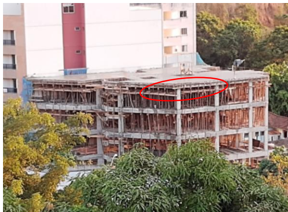
Figura 7- Obra 12 Não Conforme para Fechamento Provisório nos pisos
