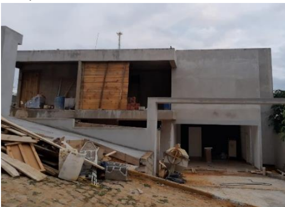
Figura 17- Obra 21 Não Conforme para Organização e limpeza
