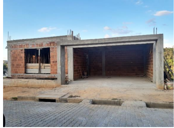
Figura 16- Obra 10 Não Conforme para Sinalização
