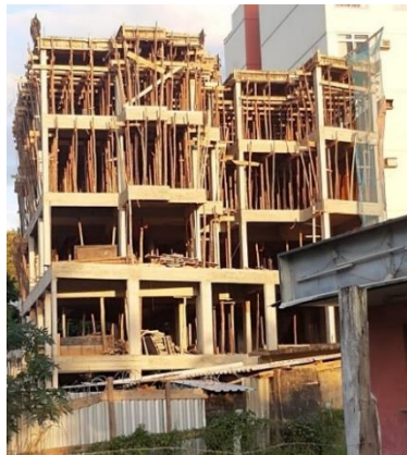
Figura 12- Obra 12 Não Conforme para Instalação da plataforma Fonte: Autor(es), 2020
