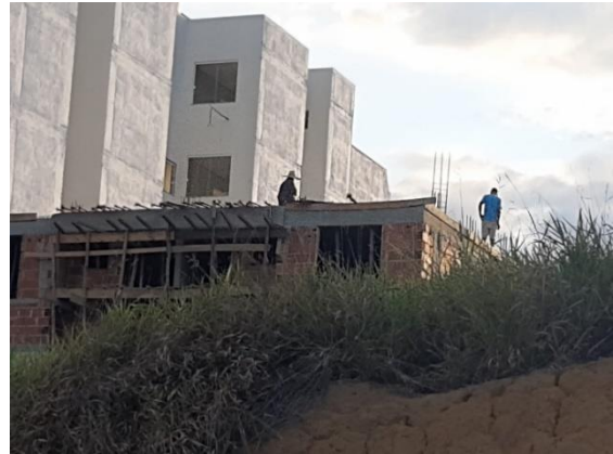
Figura 14- Obra 8 Não Conforme para EPI Fonte: Autor(es), 2020
