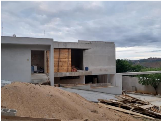
Figura 21- Obra 21 Não Conforme para Barreiras
