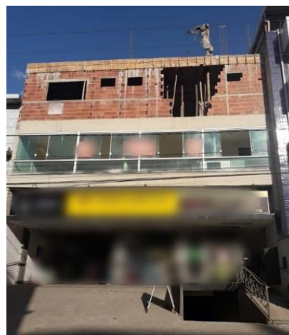
Figura 20- Obra 4 Não Conforme para Remoção de entulhos Fonte: Autor(es), 2020
