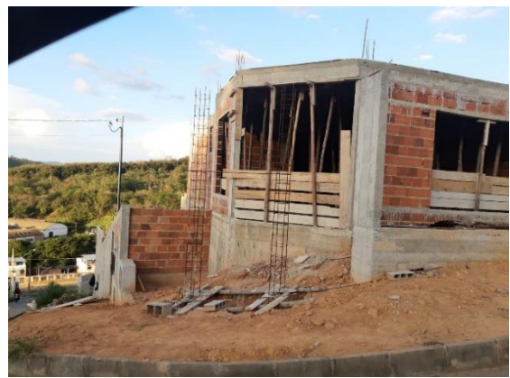
Figura 24- Obra 10 Não Conforme para Altura Mínima
