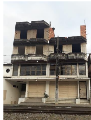
Figura 11- Obra 5 Não Conforme para Proteção periférica da edificação
