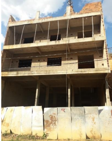
Figura 8- Obra 2 Não Conforme para Fechamento no Transporte de carga vertical
