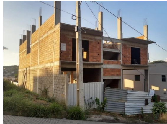
Figura 6- Obra 11 Não Conforme para Proteção Coletiva
