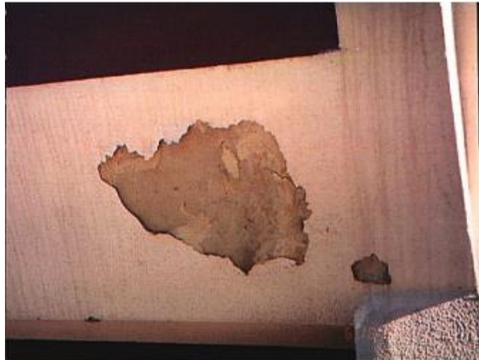
FIGURA 7 - Deslocamento do Revestimento
