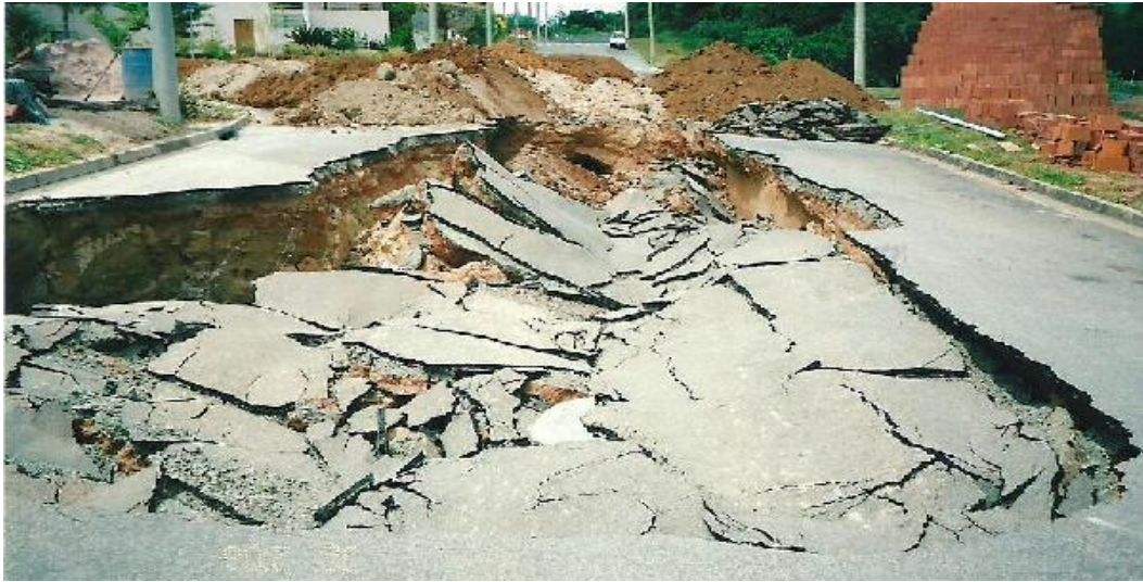
FIGURA 6 – AFUNDAMENTO DE RUA
